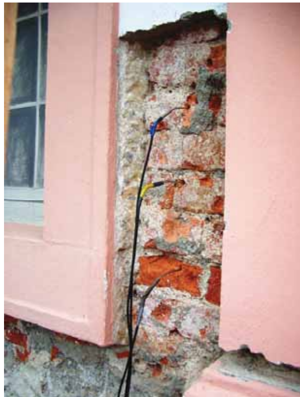
Temperaturmeßfühler, in spezielle Bohrungen eingesetzt
