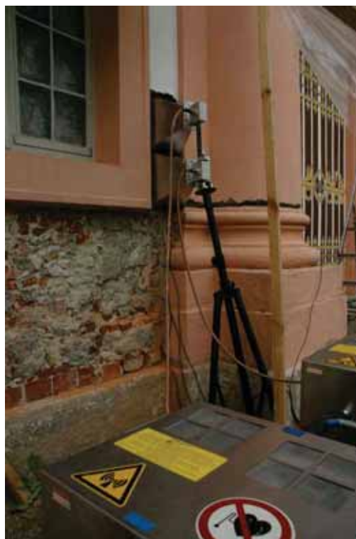
Abb. 122 Antennenstellung an der Außenwand
