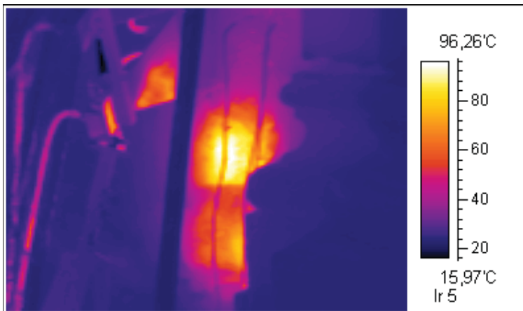
Durchwärmungskontrolle für die Antennenstellung im oben gezeigten Bild
