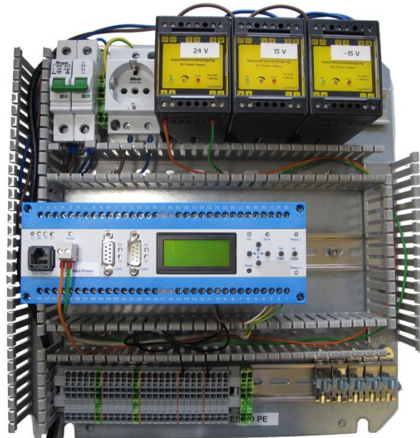
Abbildung 27: System zur Erfassung von Messdaten aus Außenmessungen. Im mittleren Bereich ist der Datenlogger zu erkennen, der die analogen Signale, die von den Sensoren kommen, aufzeichnet. Im oberen Bereich sind AC-Sicherungen und Netzteile angeordnet.
