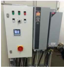
Abb. 5: Schaltschrank mit FU, Sinusfilter und Energiezähler
