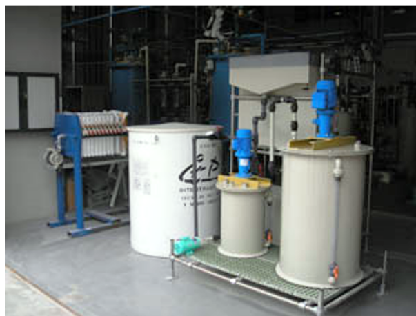
Abbildung 3.11: Industrieprototyp einer Elektrokoagulationsanlage für Abwasser [dEayE]
