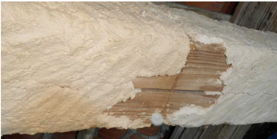
Abb. 41 Naumburg, Dom; Feld 2 Zustand nach Kompressenentsalzung (11.3.2014)
