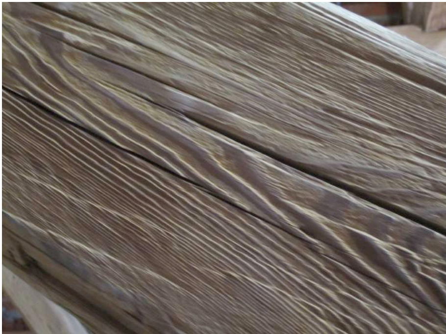
Abb. 14 Meissen, Albrechtsburg (Nordseite): Waschbretteffekt nach Reinigung im Strahlverfahren
