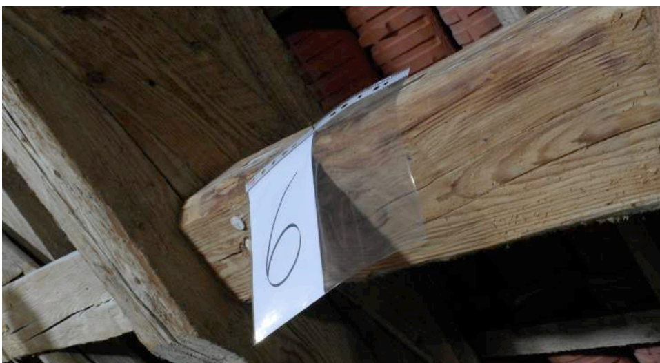
Abb. 38 Naumburg, Dom, Feld 6, Zustand nach Alkydharzbeschichtung (11.3.2014)
