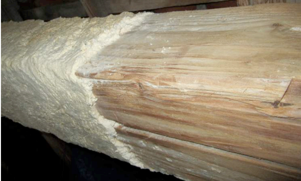
Abb. 42 Naumburg, Dom, Feld 1 Zustand nach Kompressenentsalzung (13.6.2013)
