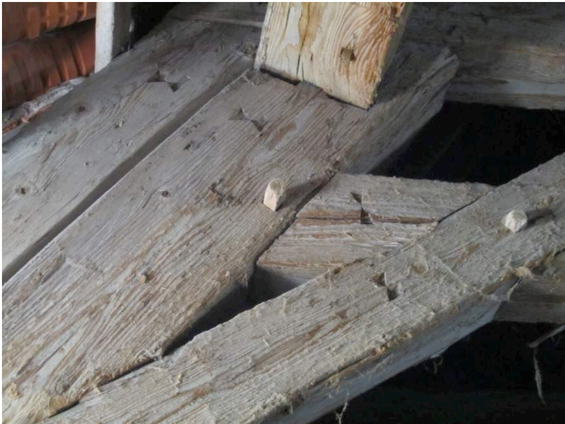
Abb. 1 Naumburg, Dom, Mazeration: Auffaserung der Holzoberfläche. Gut erkennbar sind auch die Abbundzeichen (Dreiecke, sog. „Fähnchen“)
