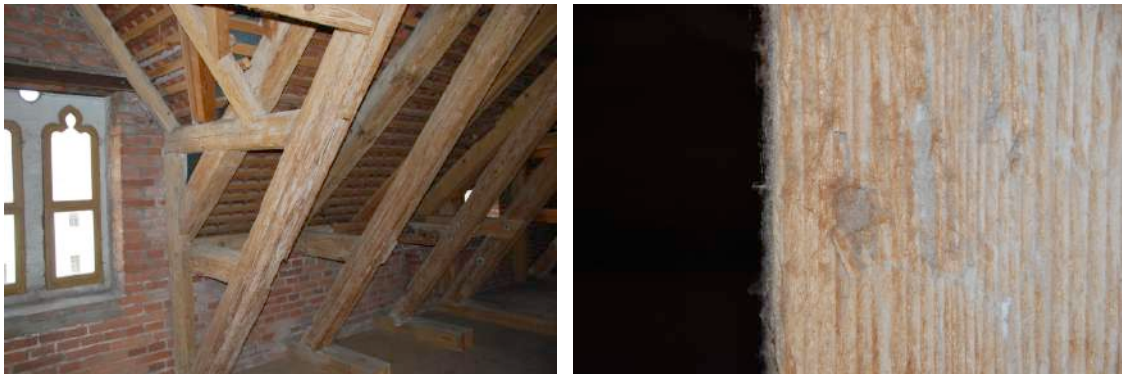
Abb. 18, Abb. 19 Wittenberg, Lutherhaus (westliches Dach): Belag und Mazeration nach Reinigung und Pufferung
