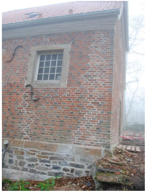
Bild 4: Sanierter Vertikalriss - Westwand
