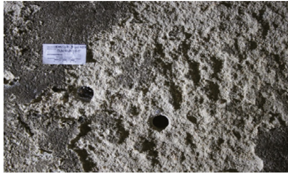
Bild 27: Bereich 05.01 Decke mit Verlust der oberflächennahen Steinzone bis in über 1 cm Tiefe
