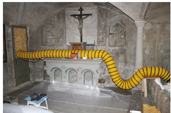
Bild 50: Absauganlage für permanenten Luftaustausch
