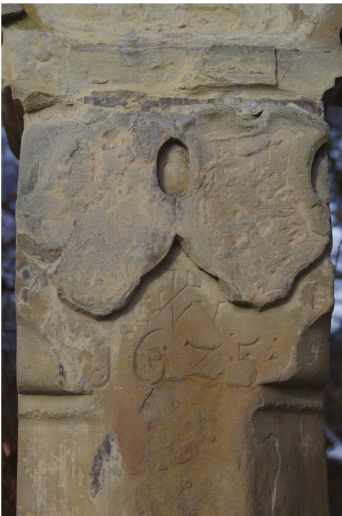
Bild 38: Verwitterter Eisensandstein mit Steinmetzzeichen
