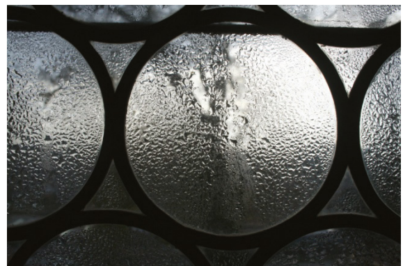
Bild 75: Kondenswasserbildung an den Fenstern
