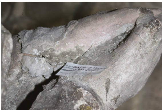
Bild 13: Christus 06.06, Mörtelergänzung aus hellem glatten Mörtel mit roséfarbener Fassung an den Händen
