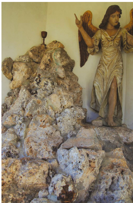
Bild 14: 2. Kapellenhäuschen: Hier wurde der Kalktuff hell überstrichen.
