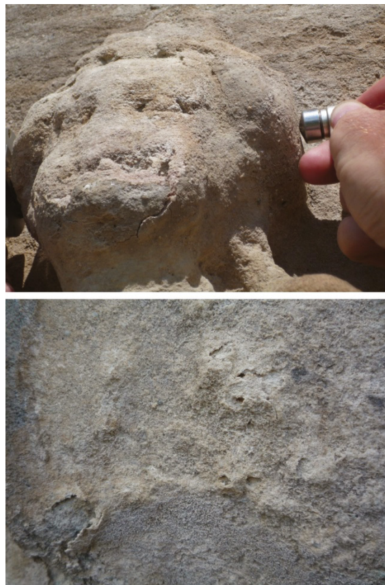
Bild 3: Aktuelle Schäden wie hohl liegende Antragsmörtel (oben) und Salzpustel auf absandenden Flächen (unten)
