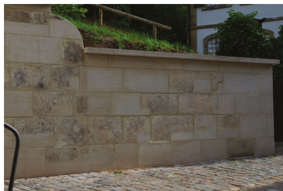
Bild 44: Sandsteinmauer an der Oberen Felsenkapelle
