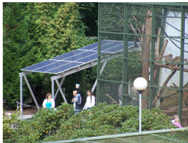
Abb. 6: Fotovoltaikplatten auf Carport
