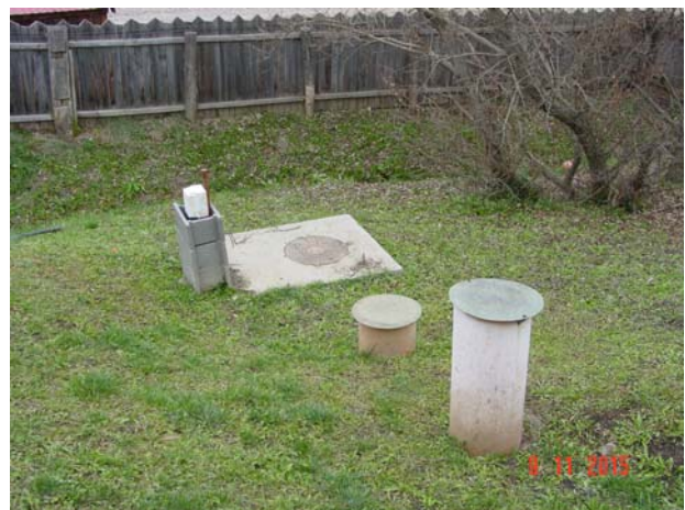
Bild 20: Pumpenschacht, Schaltkasten und Revisionsöffnungen der Vorklärung
