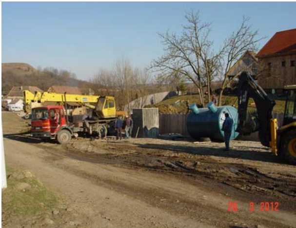
Bild 11: Anlieferung der Vorklärung
