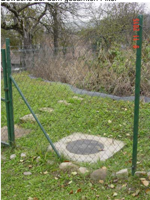
Bild 21: Kontrollschacht am Ausgang des Filterbeckens
