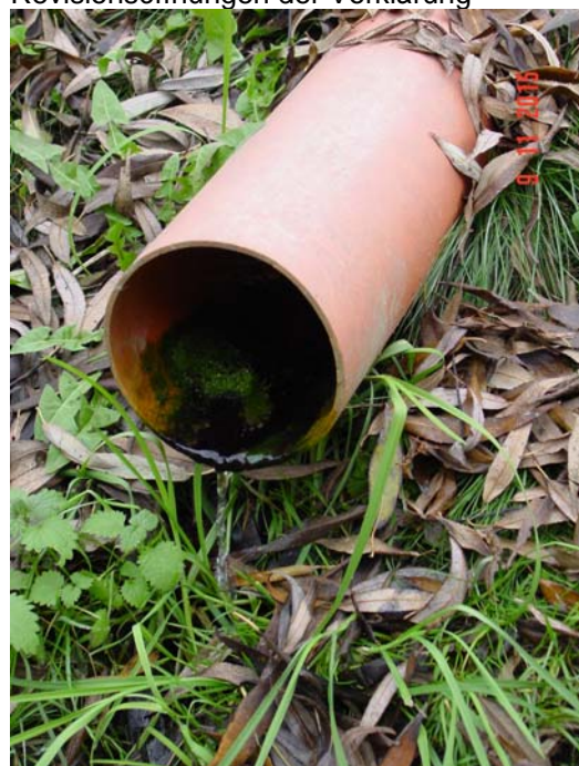
Bild 22: Auslass in den Dorfbach bei laufendem Betrieb (Nov. 2015)
