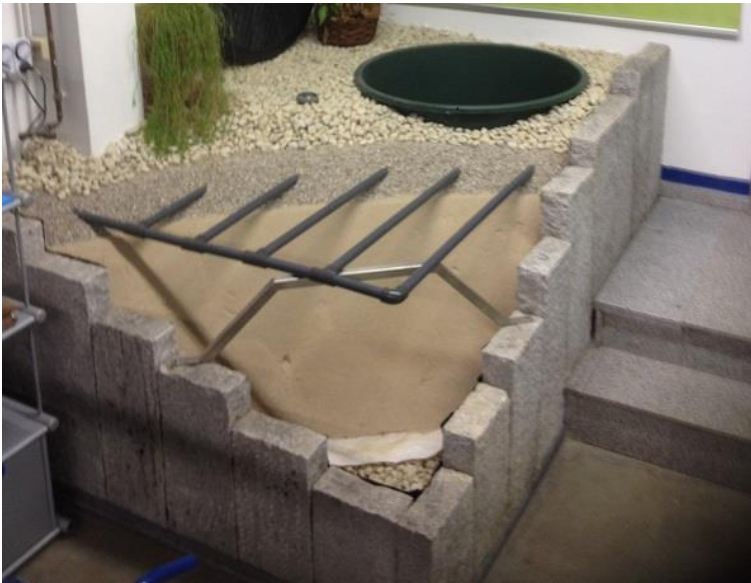
Abbildung 6-12: Weitergehende Behandlung des Abwassers mit Hilfe eines unbepflanzten Bodenfilters
