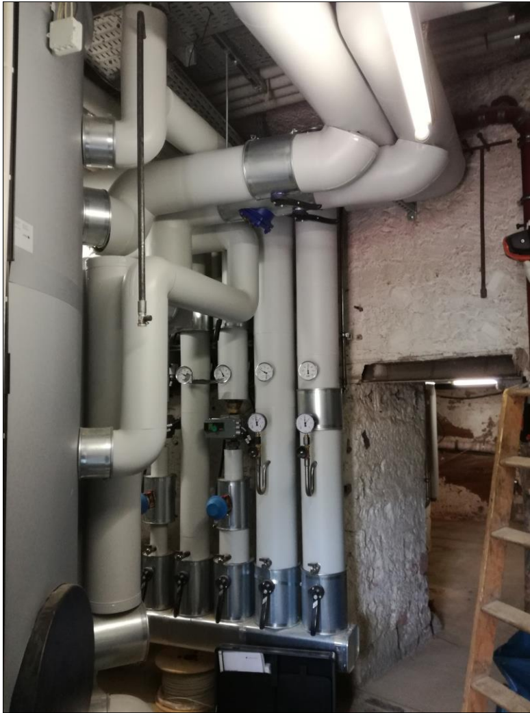
Bild 24: Die neue Heizungsverteilung im alten Heizraum -1.07, links der 10 m 3 Pufferspeicher, AB Haase
