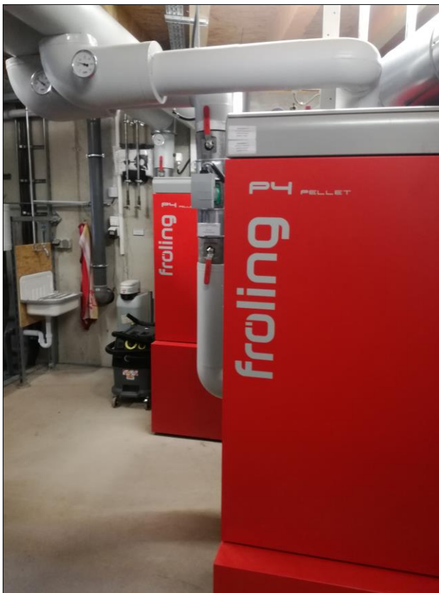
Bild 22: Die Pelletkessel in der neuen Heizzentrale, AB Haase
