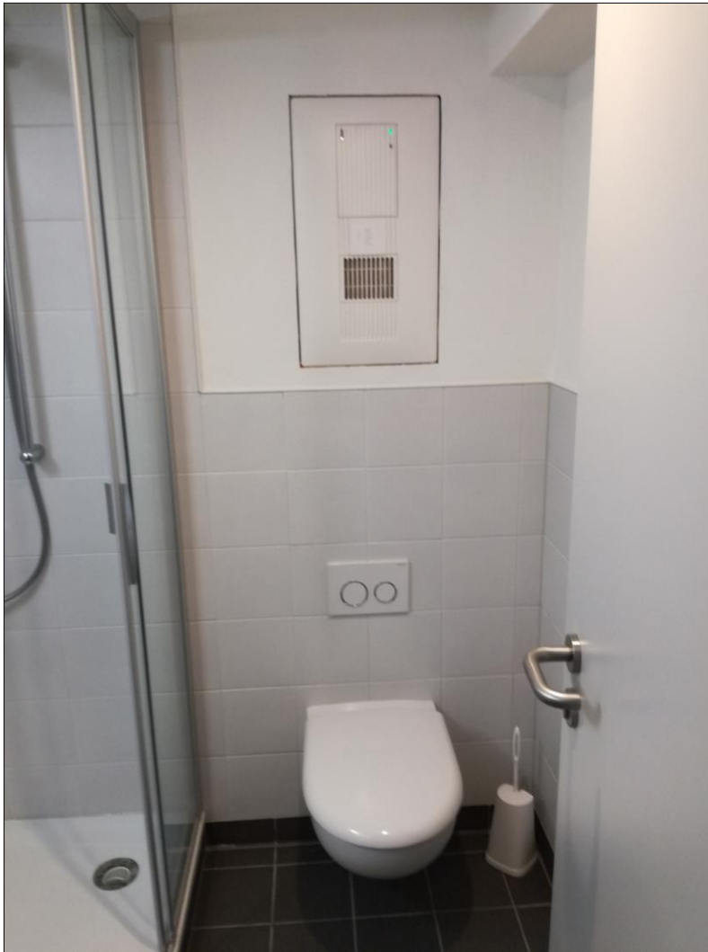
Bild 26: Einzellüftungsgerät mit Wärmerückgewinnung in der neuen Sanitärzelle des Zimmers „Rom“, AB Haase
