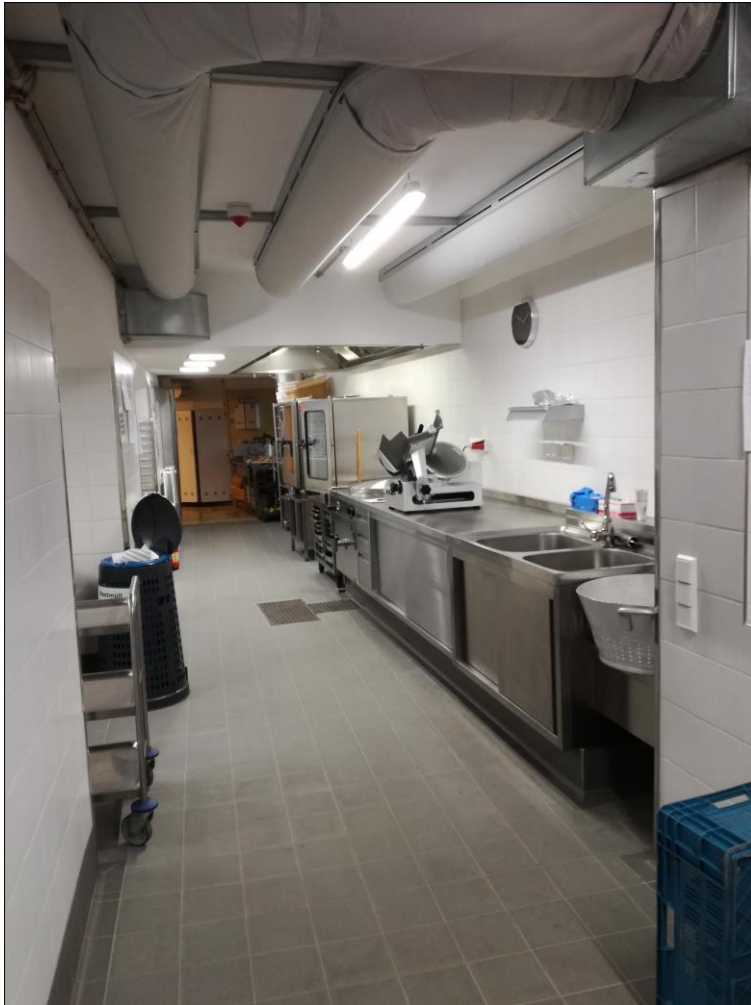
Bild 27: Die neue Abluftanlage im umgebauten Bestandsraum der Küche, AB Haase
