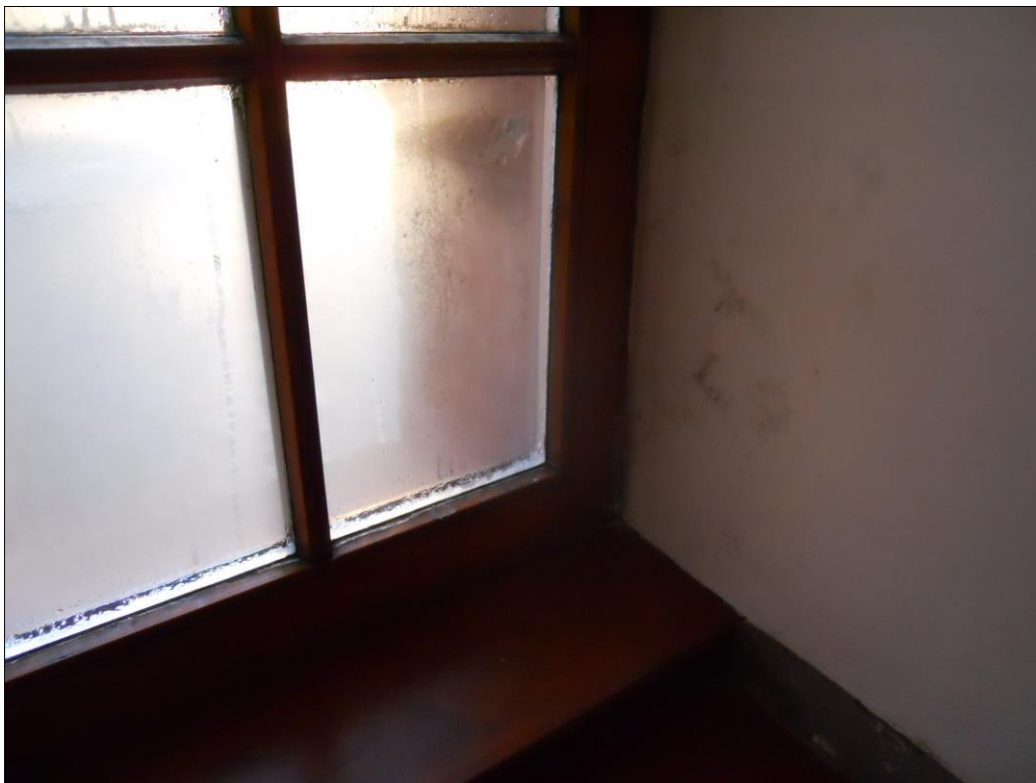
Bild 15: Kondensat und Schimmelbefall an den Treppenhausfenstern des Wohnturms vor der Sanierung, AB Haase
