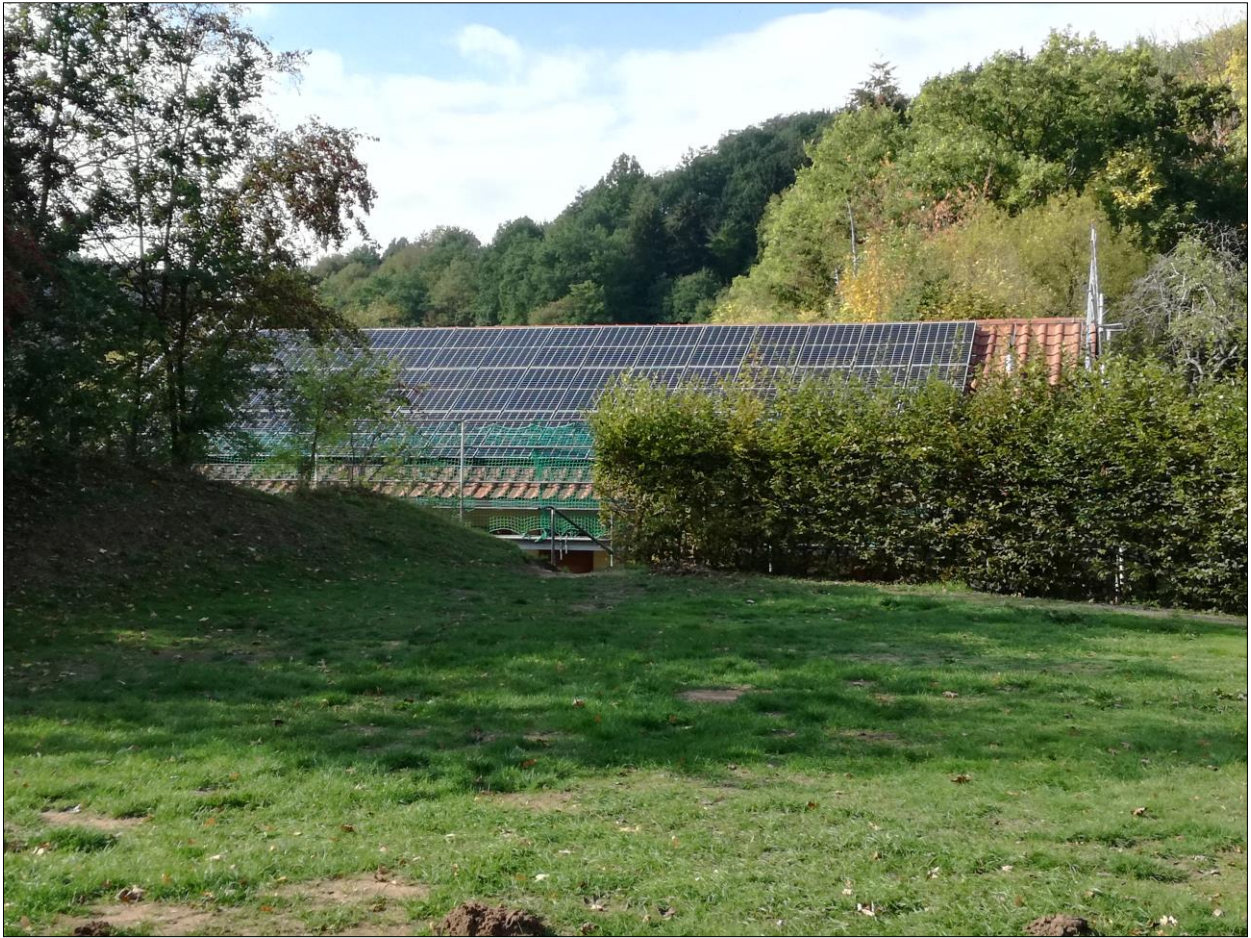
Bild 25: Die Photovoltaik-Anlage auf dem Sanitärgebäude des Zeltplatzes, AB Haase
