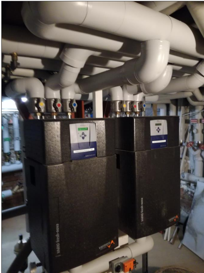
Bild 20: Frischwasserstationen im alten Heizraum -1.08, AB Haase
