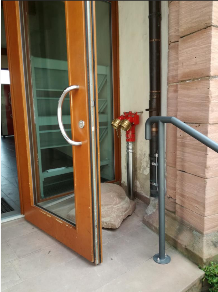
Bild 45: Die Anschlussarmatur der neuen, trockenen Feuerlöschleitung am Eingang zum Saalgebäude, AB Haase
