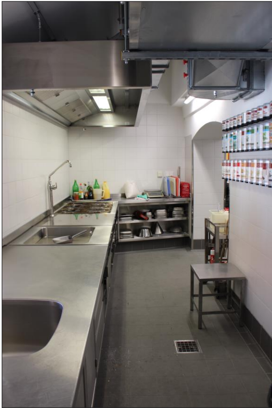
Bild 35: Die warme Küche im Anbau, mit Herd, Griddleplatte und Abluftanlage, AB Haase
