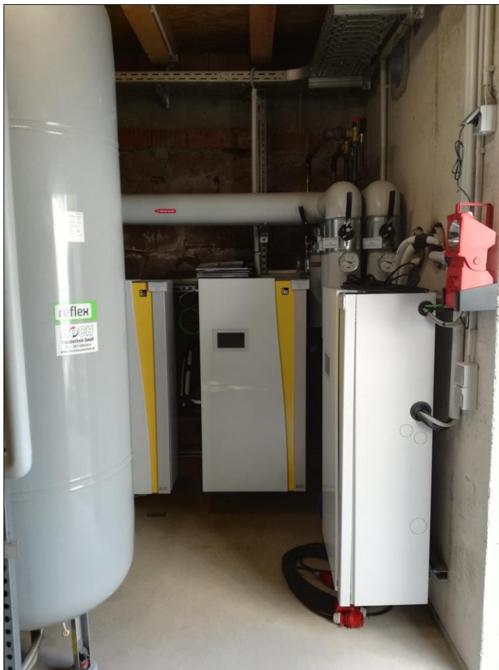
Bild 19: Die Luft-Wasser-Wärmepumpen in der neuen Heizzentrale, AB Haase
