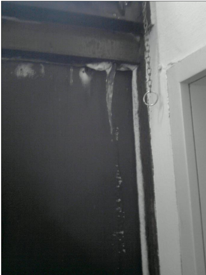
Bild 14: Eiszapfen auf der Innenseite der Eingangstür zum Wohnturm (Bt. F), vor der Sanierung, AB Haase
