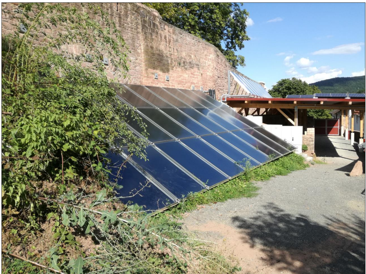
Bild 48: Solarthermie, Photovoltaik und Wärmepumpen in der Kombination mit Lagerflächen, AB Haase
