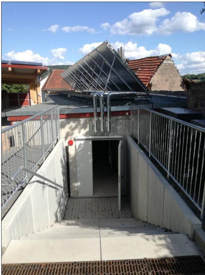
Bild 18: Solarthermieanlage auf dem Dach der Heizzentrale, AB Haase
