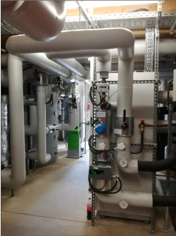
Bild 21: Die Hochtemperatur-Wärmepumpe und der Kaltspeicher in der neuen Heizzentrale, AB Haase
