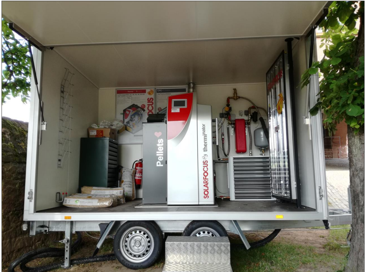
Bild 50: Hotmobil für die TWW-Erzeugung während der Bauphase im Sommer 2018, AB Haase
