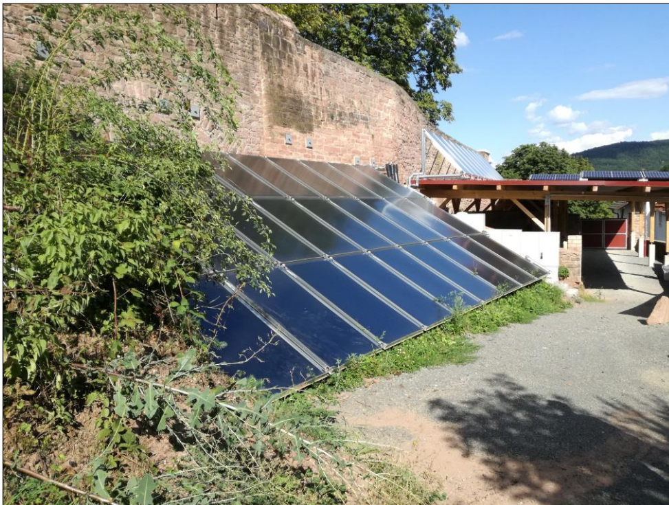
Bild 17: Thermische Solarkollektoren in Freilandaufstellung und auf der Lagerhalle, AB Haase
