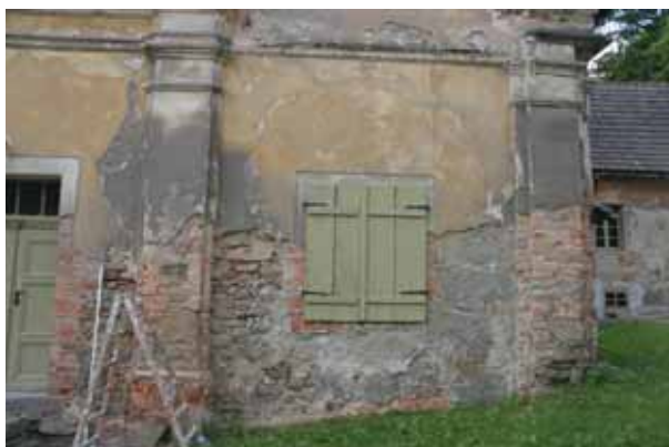
Abb. 26 Beamtenhaus, Giebel, rechtes Fenster mit umlaufendem Riss
