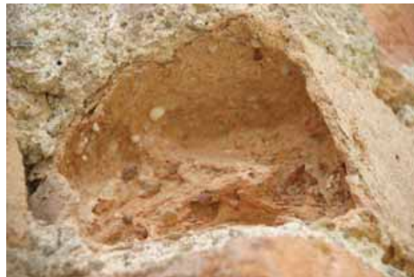
Abb. 23 Beamtenhaus, Giebel, Pilaster, Schäden an einzelnen Ziegeln
