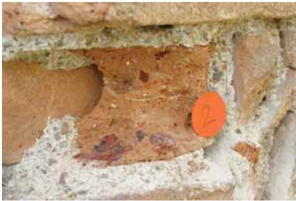
Abb. 55 Beamtenhaus, Giebel, Pilaster, Schäden an einzelnen Ziegeln
