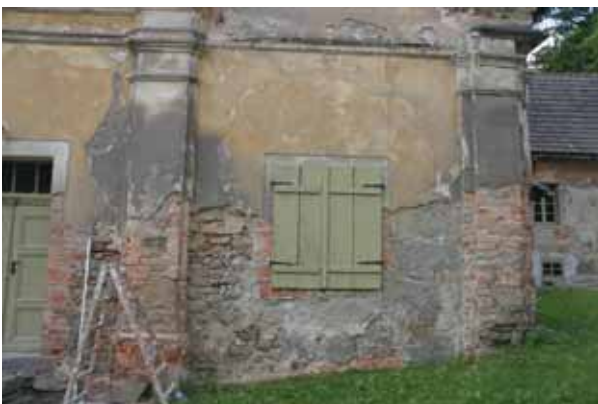
Abb. 59 Beamtenhaus, Giebel, rechtes Fenster mit umlaufendem Riss
