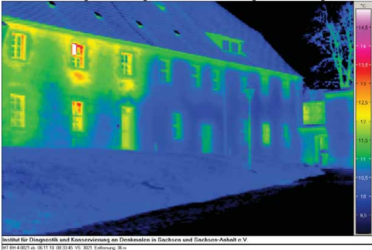
Abb. 74 Südostfassade Haupthaus, rechter, östlicher Teil, zum Untersuchungszeitpunkt keine Nutzung/Beheizung, Abzeichnen der Mauerwerksstrukturen und Fensternischen im bewohnten Teil, ganz links
