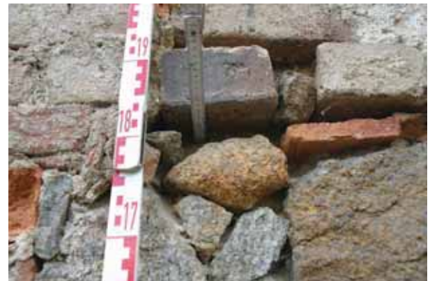
Abb. 58 Beamtenhaus, Giebel, Fassade rechts neben Tür, Fugenmörtel auswaschungen bis zu 10 cm
