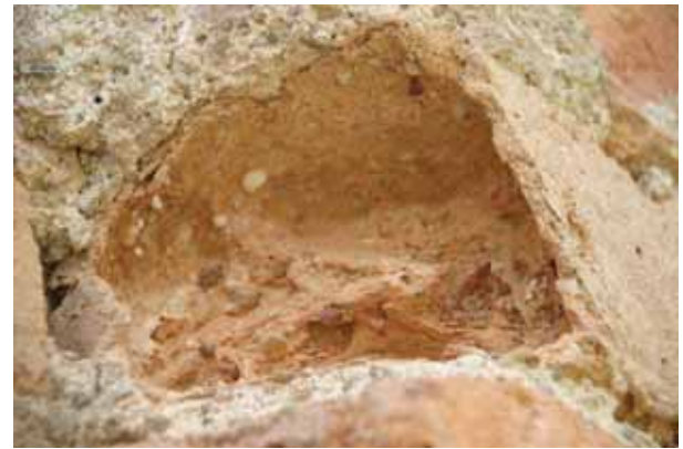
Abb. 56 Beamtenhaus, Giebel, Pilaster, Schäden an einzelnen Ziegeln
