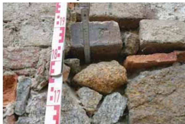
Abb. 25 Beamtenhaus, Giebel, Fassade rechts neben Tür, Fugenmörtel auswaschungen bis zu 10 cm
