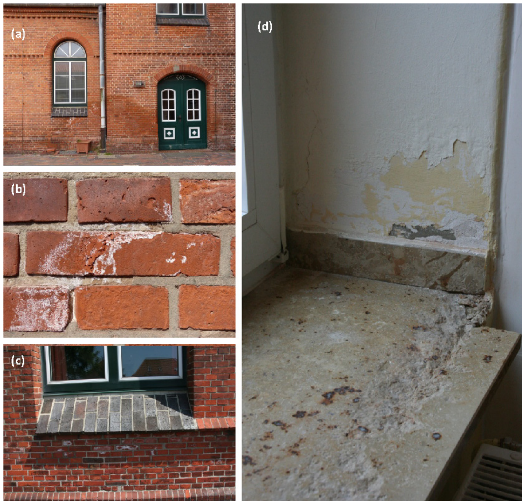
Abb. 21: Mauerwerksdurchfeuchtung und Salztransport. (a) lokale Mauerwerksdurchfeuchtung durch defektes Regenfallrohr (Südseite, Gebäudemitte); (b) Ziegelzerstörung durch leichtlösliche Salze in der Trocknungszone der lokalen Feuchtequelle (Ausschnitt aus a); (c) vornehmlich in den Sommermonaten erfolgt die Kristallisation der durch Feuchte mobilisierten Salze, die über defekte Fugen der Sohlbänke in das darunter liegende Mauerwerk eindringen konnte; (d) durch von außen über defekte Abdichtungen an den Fensterrahmen eindringende Feuchtigkeit führt zusammen mit Salzen zu Schäden an den Fensterbänken aus Jurakalk (Klassenraum Westseite).
