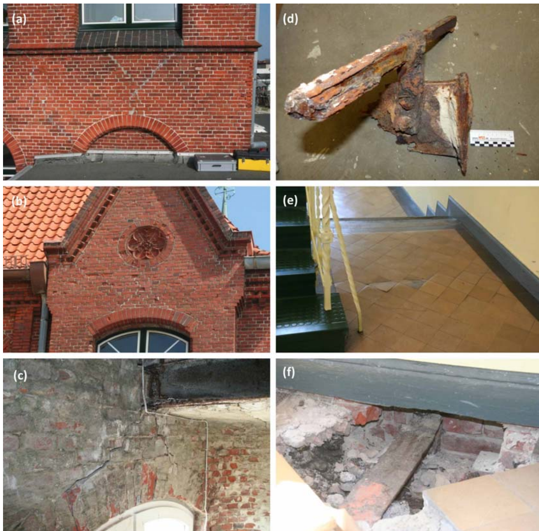
Abb. 23: Schäden durch korrodierende Deckenträger aus Eisen. (a) massive Rissbildung im Ziegelmauerwerk, die mehrfach ausgebessert wurde, aber nicht nachhaltig und dauerhaft behoben werden konnte (Westseite, Ostrakt); (b) analoges Beispiel der Rissbildung über dem Erker mit dem Wendeltreppenzugang zum Dachboden auf der Westseite; (c) Ansicht der Rissbildung und der Korrosion des Trägers von innen (Wendeltreppenzugang zum Dachboden auf der Westseite); (d) abgeschnittener und ausgebauter, stark korrodierter Trägerkopf mit angenietetem Querriegel (Westseite, Ostrakt); (e) parallel zum Träger verlaufender Riss im Belag des Flurfußbodens (Innenbereich, Flur); (f) Bestätigung der Ursache des Trägers als Ursache des Risses durch Sondierungsöffnung (innen).
