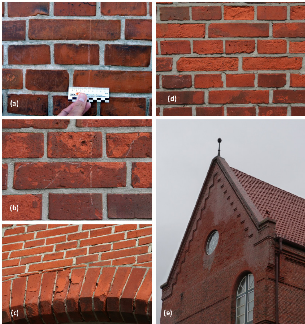
Abb. 19: Augenscheinlich intaktes Ziegelmauerwerk (a) auf der Ostseite (unterer Bereich des Erdgeschosses) und typische Schäden im Ziegelmauerwerk: (b) typische Schalenbildung auf den Ziegeln mit sukzessiver kleinteiliger Ablösung (Südseite, Osttrakt); (c) großflächigere Schalenbildung auf Ziegeln eines Fenstersturzes (Westseite); (d) rückgewitterte Ziegeloberflächen nachdem Verlust der Brennhaut als Schale (Westseite); (e) deutlich sichtbarer Unterschied in den Saugfähigkeiten der Ziegel mit und ohne Brennhaut (Nordseite, Osttrakt, Aufnahme erfolgte unmittelbar nach einem starken Regenschauer).
