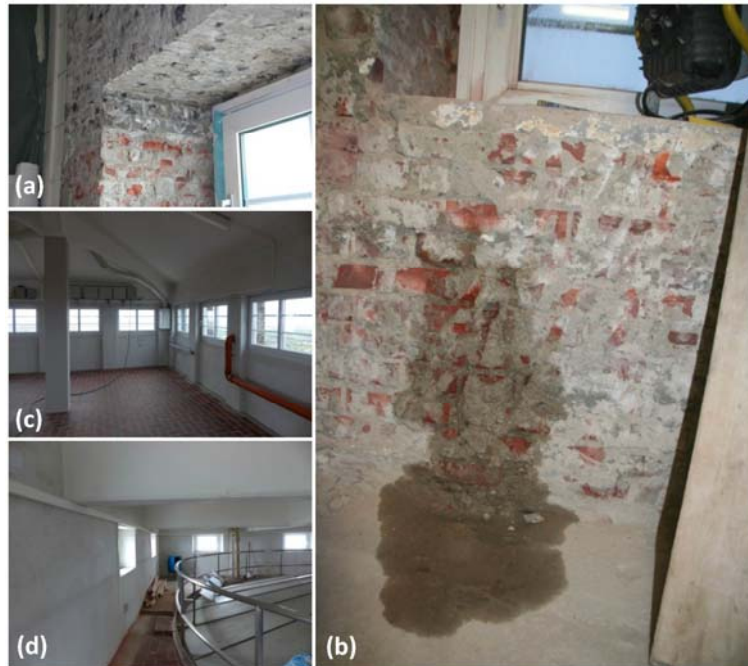
Abb. 100: Instandsetzung im Innenbereich. (a) Fensterleibung nach Entfernung der Wandfliesen; (b) Wasseraustritt aus der Wand noch einige Wochen nach Entfernung der Wandfliesen; (c) Aussichtsraum nach Neuverputz, (d) Umgang um den Wasserbehälter nach Neuverputz der Innenseiten der Außenwände.
