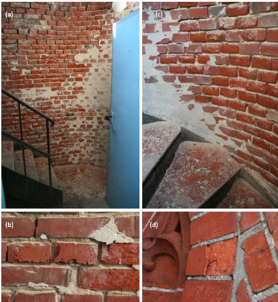
Abb. 22: Schäden am Treppenturm durch Salze und Frostschäden. (a) Wendeltreppenaufgang zum Dachboden (Westseite innen): der ursprüngliche Putz ist durch Feuchte- und Salztransport von außen und Kristallisation der Salze an der Grenzfläche zwischen Ziegelmauerwerk und Putz zerstört worden; (b) Schädigung von Mauermörtel und Ziegeln durch Salzkristallisation nach dem Verlust des Putzes; (c) im Zeitraum von ca. 20 Jahren angereicherte Ablagerungen des Ziegel- und Fugenmörtelmaterialverlustes auf den Treppenstufen; (d) scherbiger Ziegelzerfall, wie er typisch für Frostsprennung ist (Westseite, Erker).
