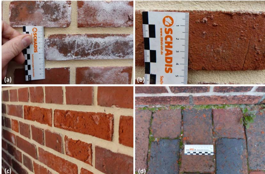
Abb. 48: Fortdauernde Verwitterung nach Instandsetzung des Fugennetzes. (a) Salzausblühungen (vermutlich Gips); (b) kleine Pusteln und Aufbeulungen; (c) Verwitterung von Ziegeln ohne Brennhaut durch zyklische Salzkristallisation; (d) herabgefallene Schuppen von Ziegeln.
