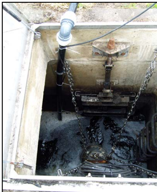
Abbildung 10: Blick in den Ablaufschacht der Nachklärung, mit Rohrleitung als Verbindung zwischen Tauchpumpe (eingetaucht im Wasser) und Lysimeteranlage.
