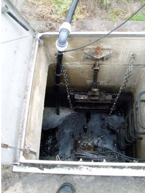
Abbildung 14 : Blick in den Ablaufschacht der Nachklärung, mit Rohrleitung als Verbindung zwischen Tauchpumpe (eingetaucht im Wasser) und Lysimeteranlage
