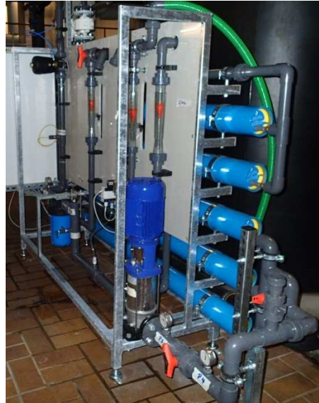
Abbildung 20. Die großtechnische NF-Anlage im Hallenbad A.
