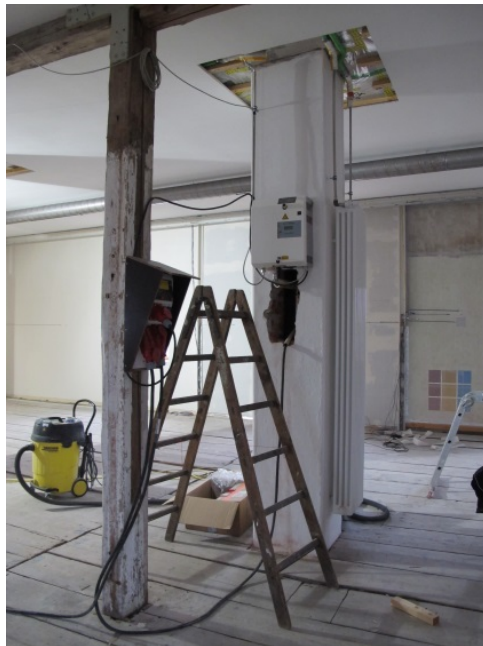
Bild 53: Befeuchter im Obergeschoss des Kopfbaus.
