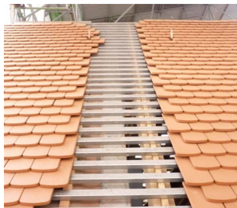
Bild 29: Lattung aus Edelstahl-Hohlprofilen, zur Ver- meidung eines möglichen Brandüberschlags zwischen Kopfbau und Südbau.
