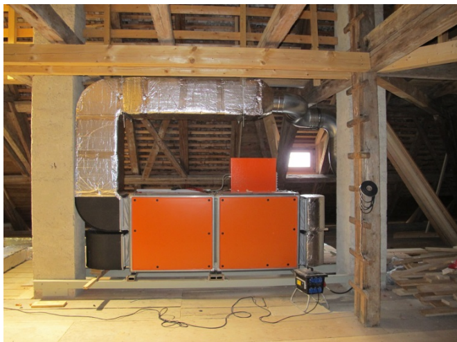
Bild 50: Klimagerät im Dachgeschoss zur Regulierung des Klimas im Obergeschoss der Alten Schäfflerei zwischen vorhandenen Kaminschächten positioniert.
