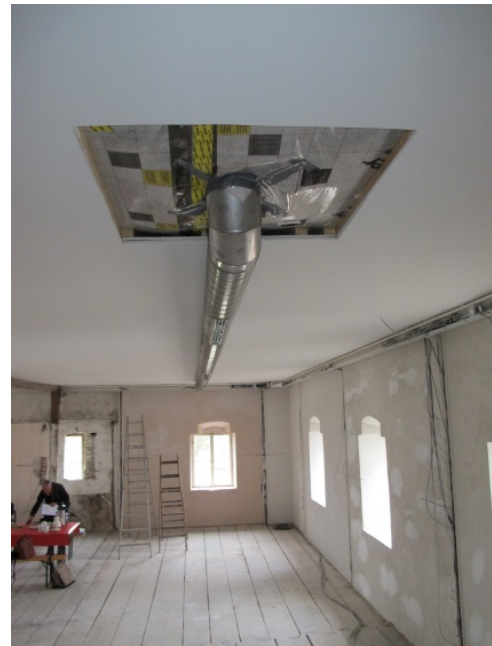
Bild 54: Abluft Kanäle im Obergeschoss.
