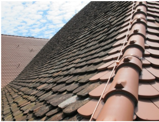
Bild 22: Blitzableiter und Blitzschutzklammern in der Gratzone des Kopfbaus.
