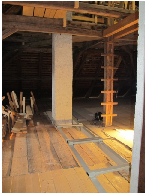
Bild 48: Stahlkonstruktion zur akustischen Entkopplung der Lüftungsanlage vom Dielenboden des Dachgeschosses.
