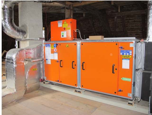
Bild 55: Lüftungsanlage im Dachgeschoss des Kopfbaus.
