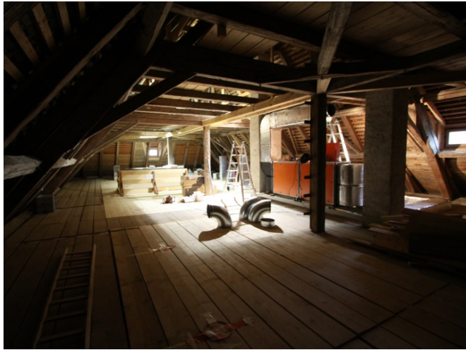
Bild 49: Blick ins Dachgeschoss mit der installierten Lüftungsanlage.
