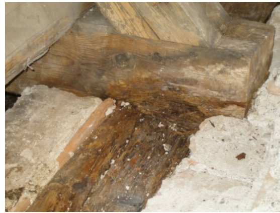
Bild 17: Schäden an eingemauerter Mauerlatte.
