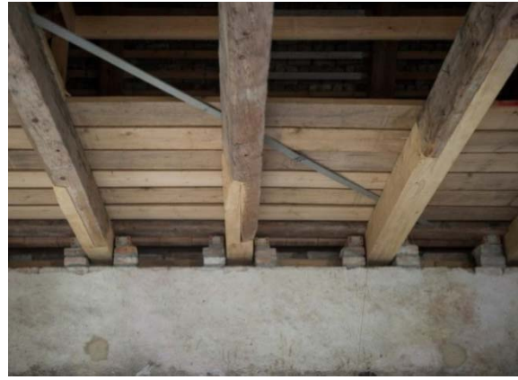
Bild 13: Balkenköpfe der Zerrbalkenebene mit diagonalem Zugeisen.
