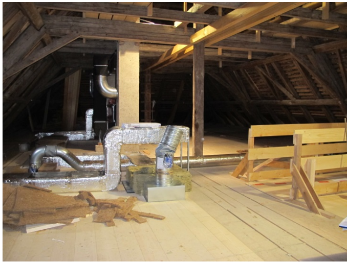
Bild 51: Kanalführung im Dachgeschoss mit Durchführung ins darunterliegende Geschoss. In diesem Bereich musste nachgebessert werden, um die Kanäle möglichst nah im Bodenbereich zu verziehen (Bild vom Vorzustand).
