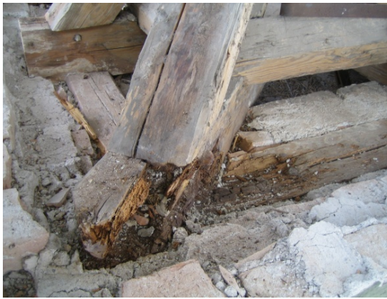
Bild 16: Fäulnisschäden am Fußpunkt des westlichen Gratsparrens und der Mauerlatte.
