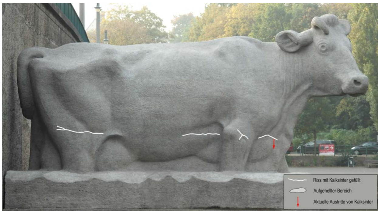
Abb. 12: Kuh, Nordseite; Kartierung der wenigen Risse, die mit Kalksinter gefüllt sind und aus denen z.T. wieder neue Sinter ausgetreten sind.
