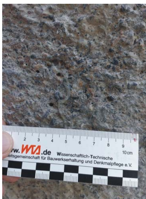
Abb. 17: Löcher in der Oberfläche, die vermutlich auch stellenweise weiterreichende Wegsamkeiten für Wasser ermöglichen.
