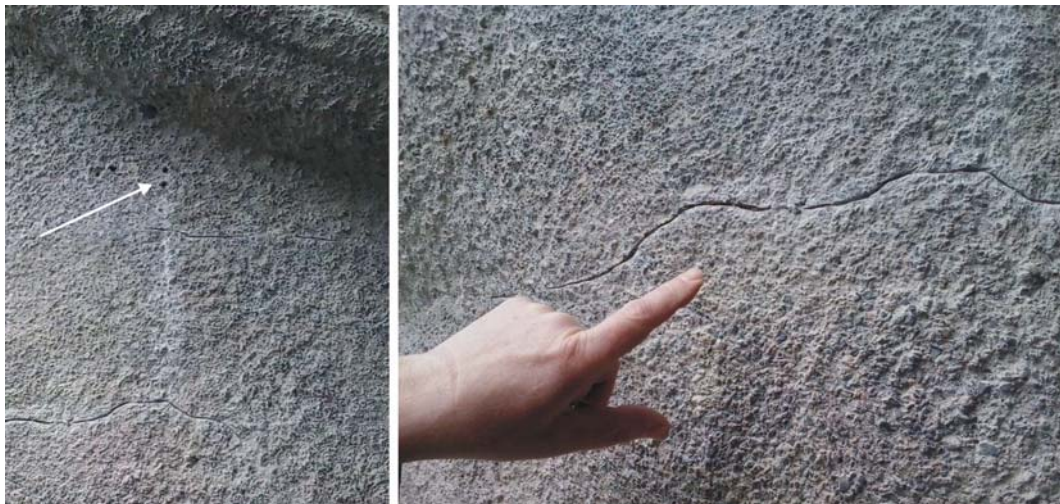
Abb. 19: Eindruck eines mit der Diamantscheibe geöffneten Risses und der aufgebohrten Löcher (links)
