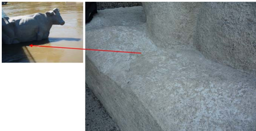
Abb. 5: Ablösung der oberflächlichen Schlämme und daraus resultierendes fleckiges Erscheinungsbild
