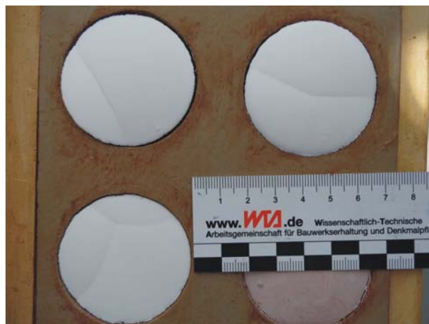
Abb. 16: Proben der Epoxidharzmörtel, die im Abbindeprozess gerissen sind und daher nicht für die Anwendung an den Skulpturen in Frage gekommen sind. Es sollte damit eine bessere Abkopplung der Sinterrisse gegen eindringendes Wasser erreicht werden.
