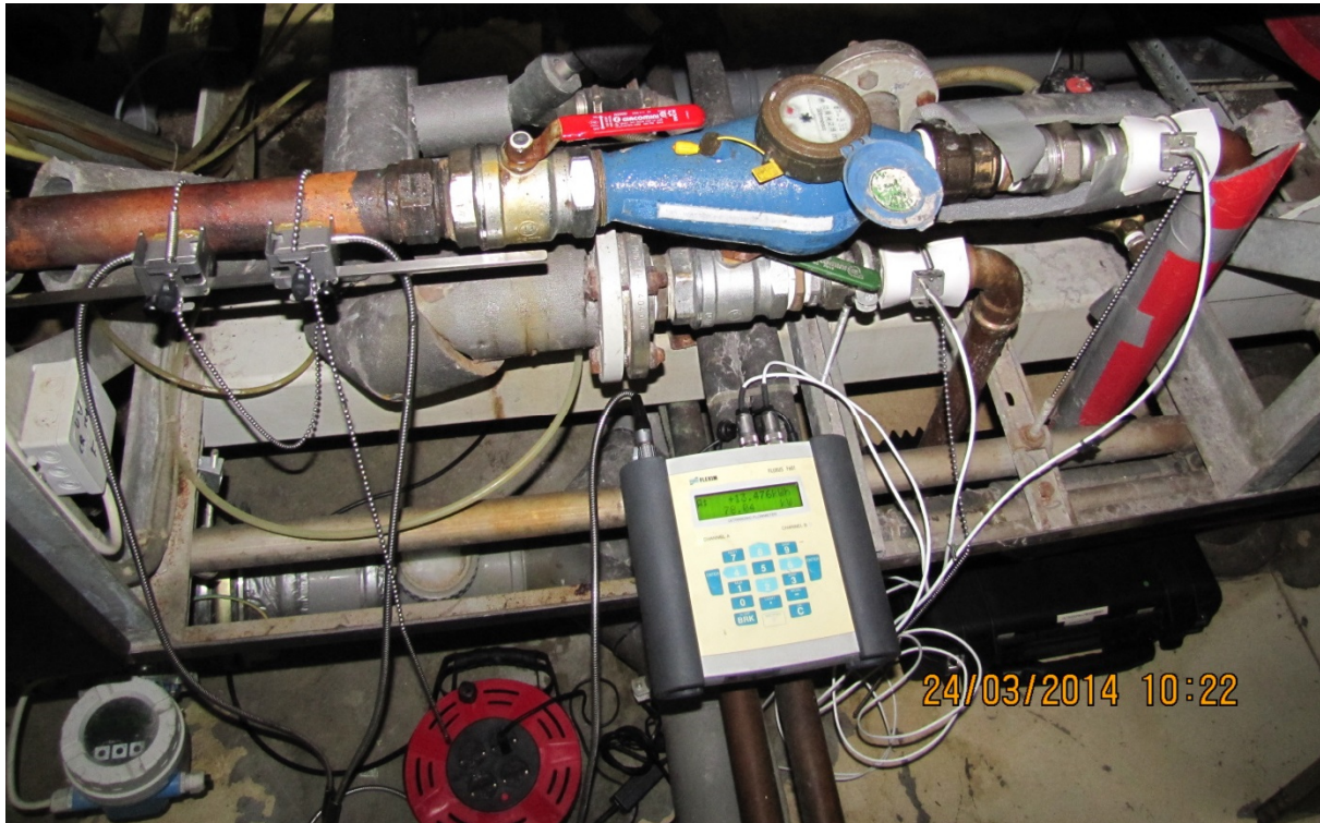
Abbildung 1: Wasserverbrauchsmessung an einer Waschstraße mit Abwasserwärmetauscher
