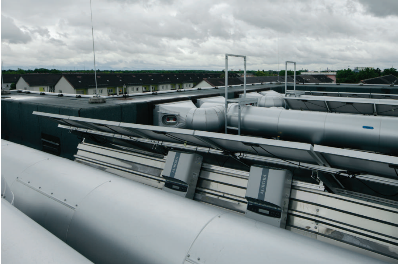
Abb. 23:Foto der Luftverteilsy- stemes auf dem Dach
