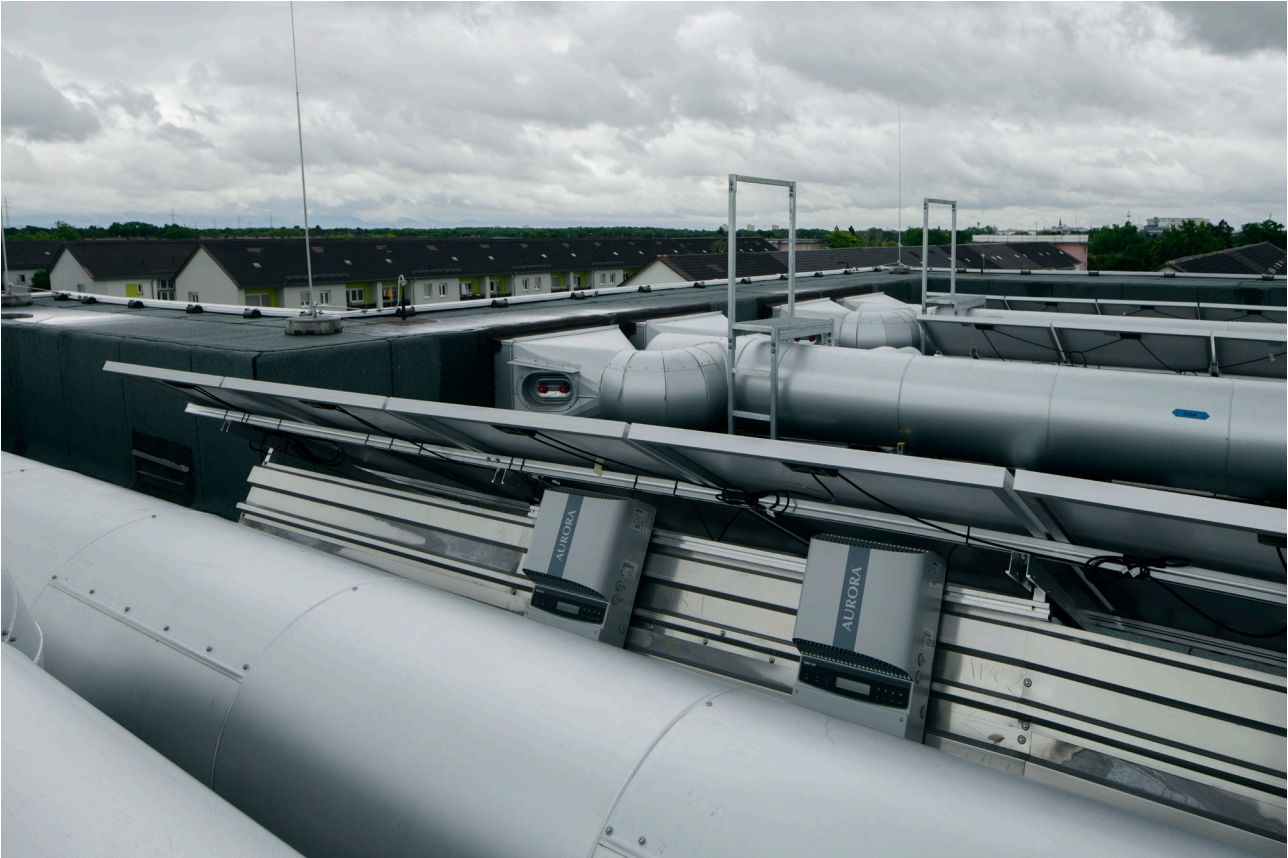
Abb. 23:Foto der Luftverteilsystemes auf dem Dach
