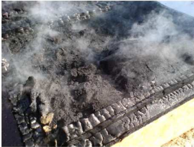
Bild 23: Wandkonstruktion nach dem Brandversuch
