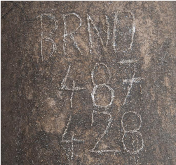
Abb. 23: Salzausblühungen an Kratzern auf der Gesteinsoberfläche.
