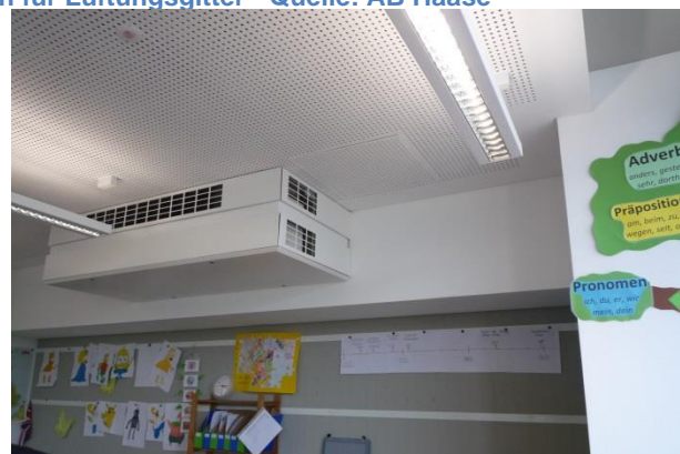
Abbildung 42: Einzellüftungsgerät mit Zu- und Abluftkanal - Quelle: AB Haase
