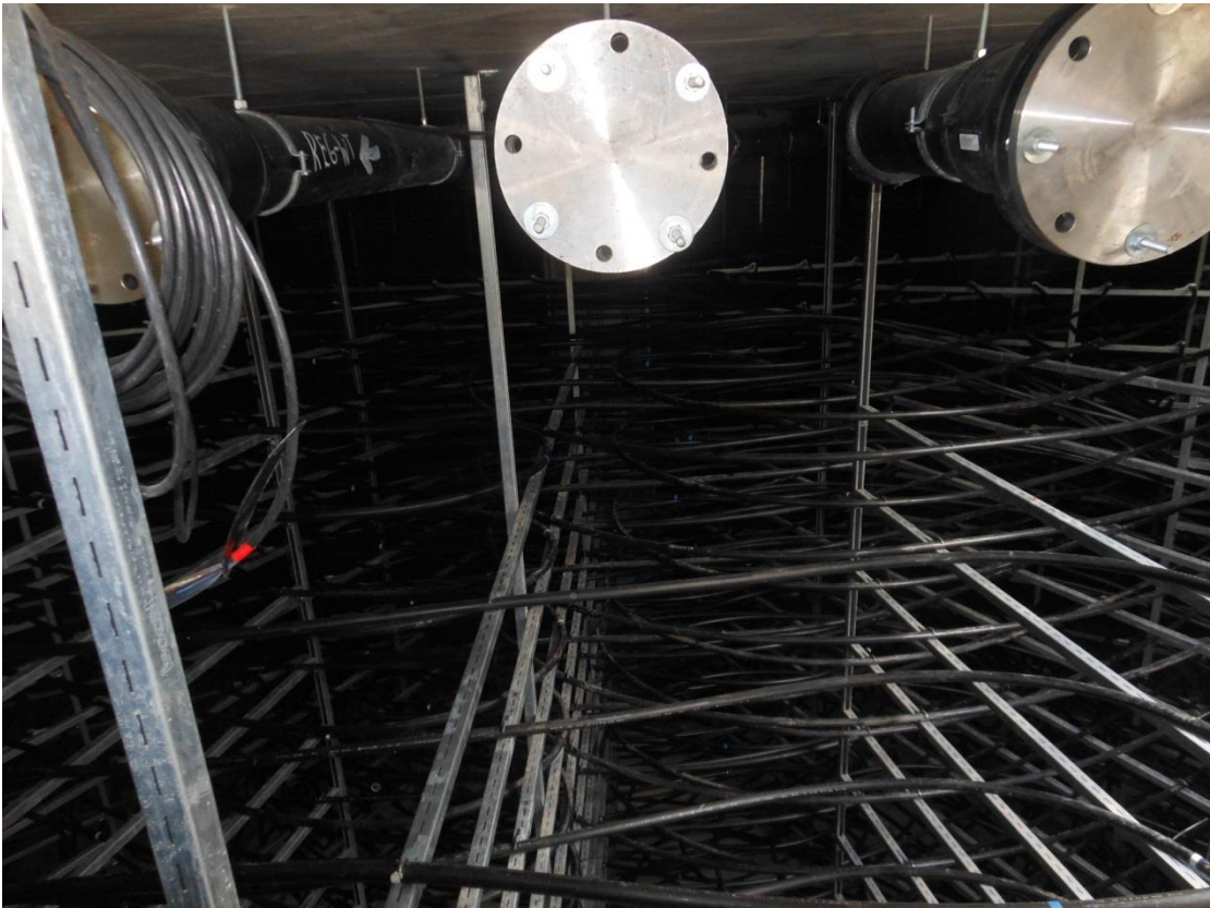
Abbildung 38: "Innenleben" des Eisspeichers - Quelle: AB Haase
