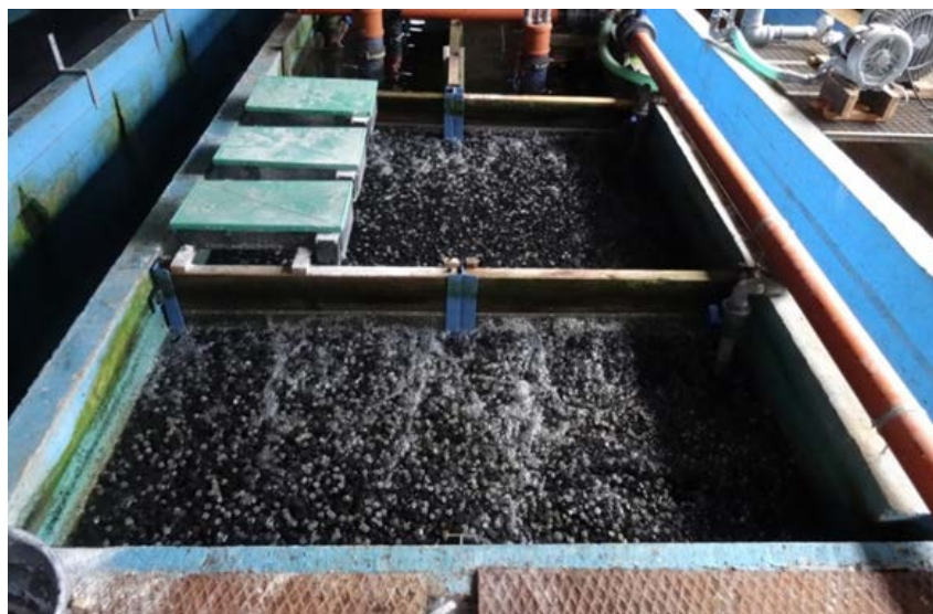
Abb. A2.6: zweistufiger Schwebbetfilter mit Bandfutterautomaten zur Dosierung des zugeführten Natrium-Hydrogenkarbonates im zweiten Abteil
