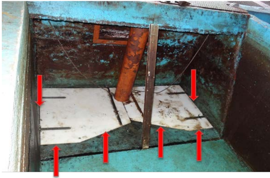
Abb. A2.3: Grundablass mit Abdeckplatten zur Schlammfernung am Ende der Rinnen hinter dem Fischgitter (mit den roten Pfeilen sind die Schlitzze gekennzeichnet durch die das Wasser beim Ziehen des Verschlussstopfen mit hoher Geschwindigkeit zum reduzierten Grundablass fließt und den Schlamm unter den Platten abgesaugt)
