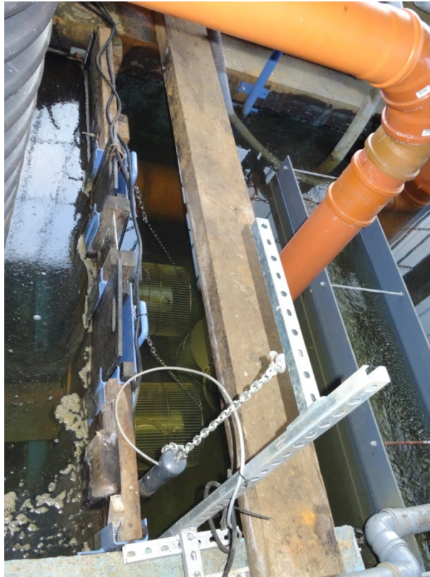
Abb. A2.9: Pumpenschottwand mit den beiden Kreislaufwasserpumpen (rechts Rinne zur Durchflussmessung)
