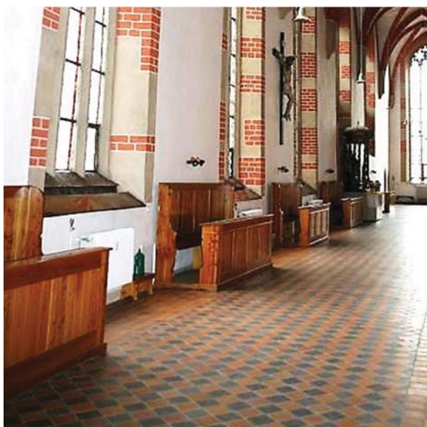
Heizkörper auf der Chorgasse
