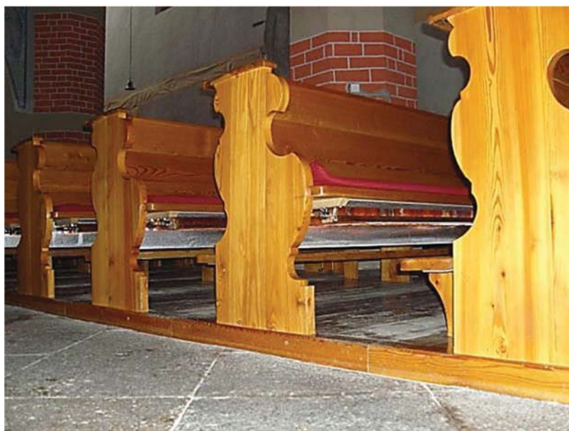
Abb. 5 warmwassergeführte Bankheizkörper unter den einzelnen Bankreihen Quelle: IDK e.V.
