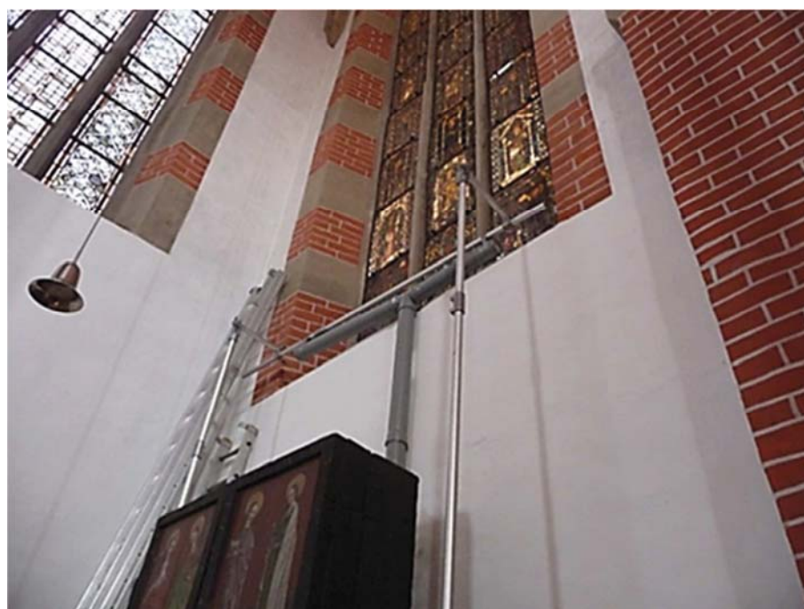
Abb. 22 Versuchsanordnung der temporären Absaugeinrichtung am Husitenfenster Quelle: Frei, Stefan (2011)
