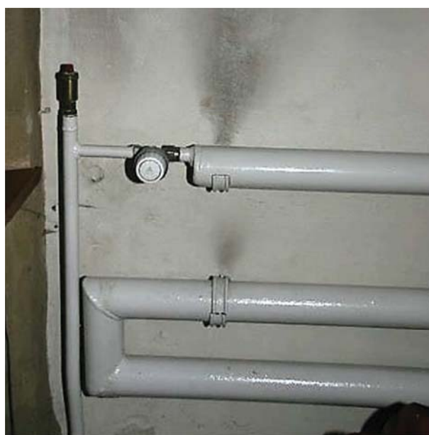
Rohrheizkörper an Wandfläche
