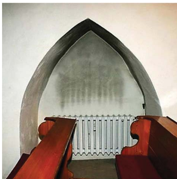
Heizkörper in Wandnischen
