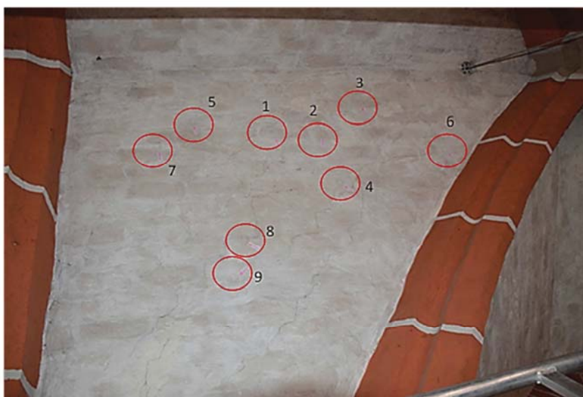
Abb. 92 Sicht auf das gedämmte Gewölbe mit den gekennzeichneten Messpunkten; (09.10.2016) Quelle: Quelle: N. Lange
