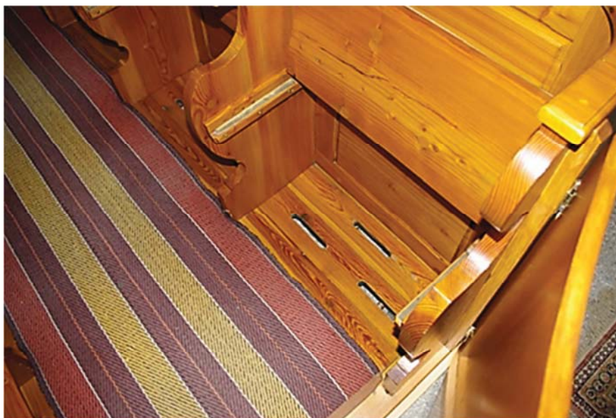
Abb. 42 Ansicht Fußbodenheizung Chorgestühl (ursprünglicher Zustand)
