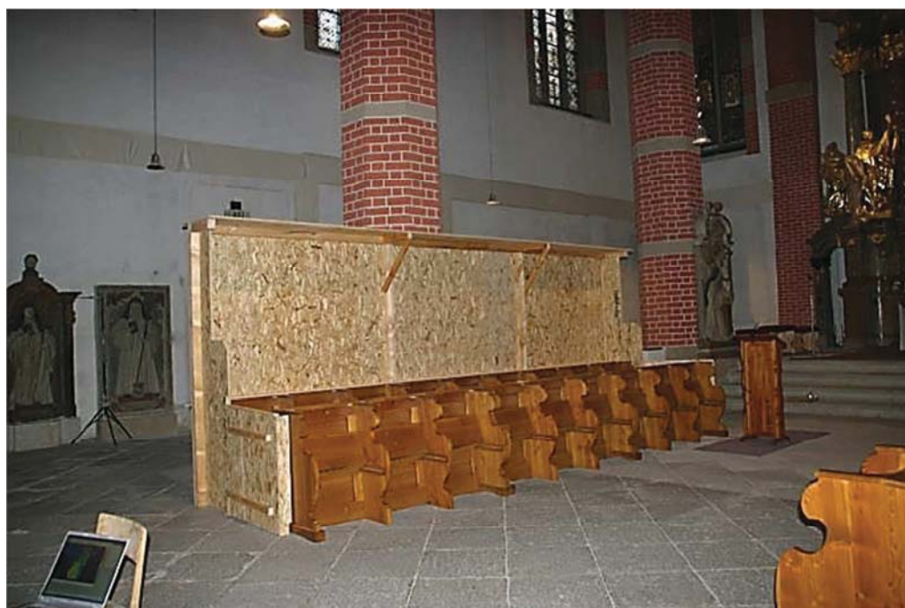
Abb. 78 Chorgestühl mit temporärer Schutzrückwand gegen Kaltluftströme (2008) Quelle: IDK e.V.
