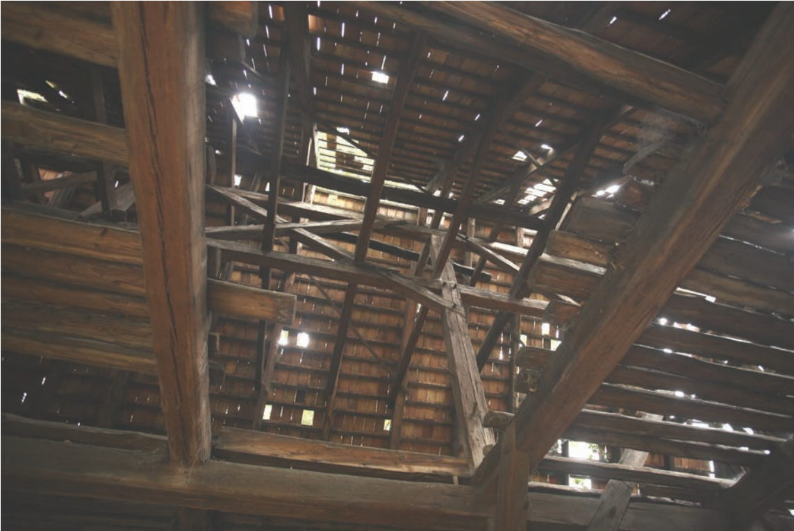
Abb. 26 Das desolate Dach der Schrottholzschneise in Zeißig bei Hoyerswerda im November 2010
