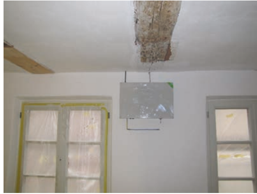
Bild 20 zeigt die Situation im Februar 2011 nach Fertigstellung der mit einem Innenputz versehenen Wand mit endgültiger Position des Gerätekastens, sowie den Oberflächentemperaturfühler und den Kombisensor für Raumlufttemperatur und -feuchte (im Unterboden des Gerätekastens).
