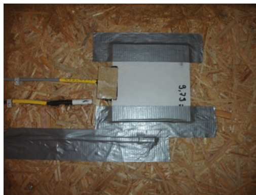
Bild 18: Temperaturfühler, Wärmeﬂuss-scheibe sowie Feuchtefühler an der Grenzschicht 3, unterhalb der Innendämmung auf der zweiten Dämmplattenebene, Foto IBP
