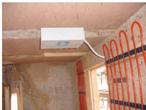
Bild 19: Ansicht der provisorischen Montage des Gerätekastens sowie der bereits aufgebrachten Wandflächenheizung im August 2010, Foto IBP
