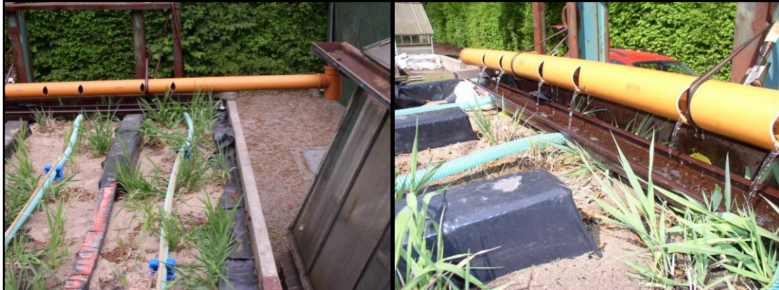
Abbildung 9: Anschluss des geschlitzten Stirnrohrs (Grobverteiler) an die Gewächshausdachrinne (li.), Überlauf des Dachablaufs vom Stirnrohr in die darunter liegende PVC-Rinne (Feinverteiler) mit angeschlossenen Bewässerungsrohren der Filter (re.).
