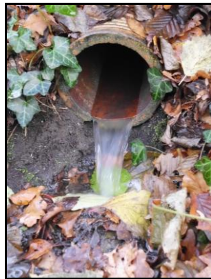
Abbildung 21: Langjährige Drainageausmündung des Gewächshausablaufs „Azaleenhaus“ in den Entwässerungsgraben als Beispiel einer diffusen Zinkbelastung von Gewässern.
