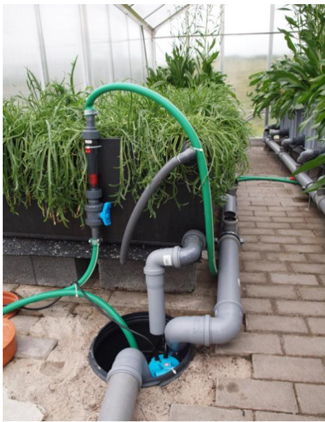
Abb. 24: Aufstellung der Lysimeter im Gewächshaus. Im Vordergrund die Prozesswasserzufuhr mit Durchflussmesser und der Rücklauf über den Pumpensumpf.
