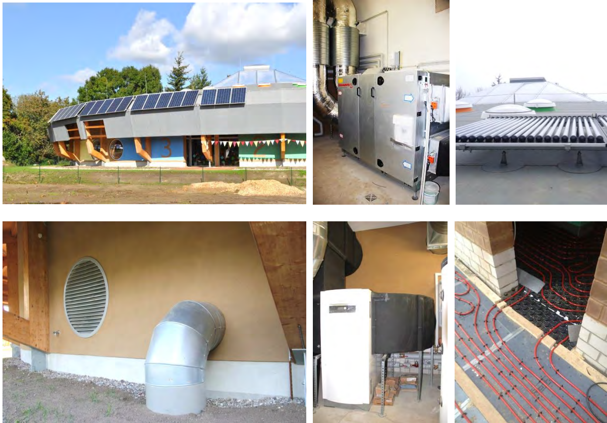
Abb.25-30 Beispiele aus dem Energiekonzept der Kita „Wildblume“; Photovoltaikanlage, Lütungsanlage mit WRG, Solarthermie und Solarkamin, Erdwärmetauscher, Luft/Wasser Wärmepumpe, Niedrigtemperatur Fußbodenheizung
