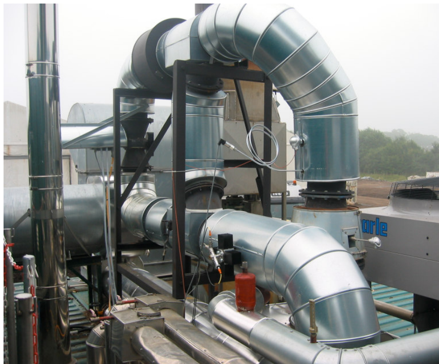
Abbildung 47: Foto der gesamten Abgasanlage
