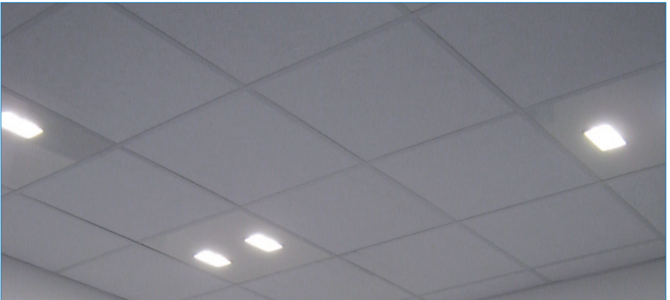
Abb. 62: Prototypen Leuchten installiert im Testbüro
