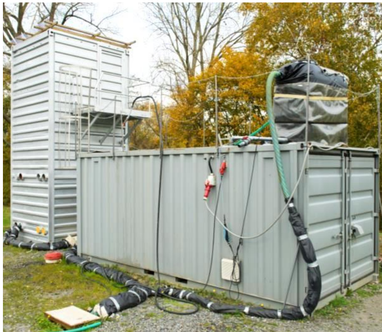
Abb. 1: Ansicht der beiden Container der Pilotanlage auf dem Gelände der Kläranlage Eversburg in Osnabrück
