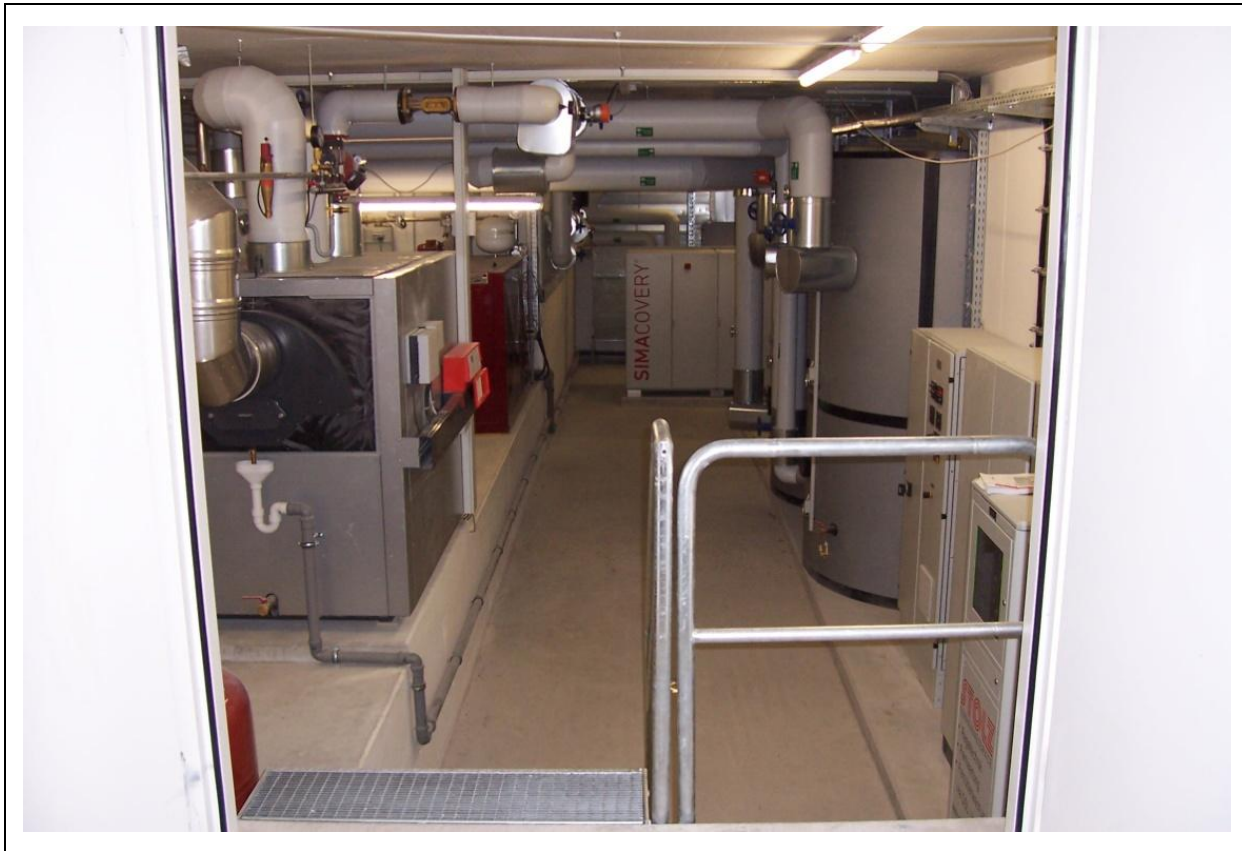
Abbildung 13: Blick in den Heizraum mit installierter Heizzentrale
