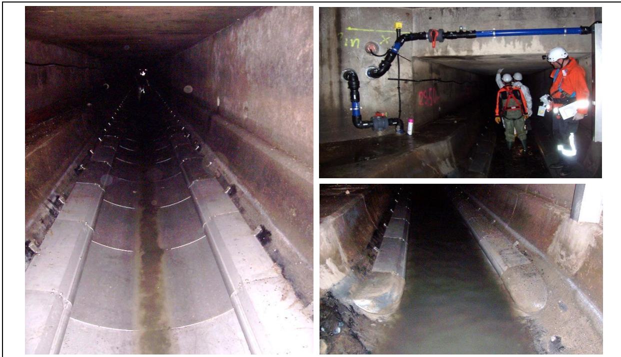
Abbildung 17: Fertig gestellter Abwasser-Wärmetauscher im Kanal, hydraulische Anbindung
