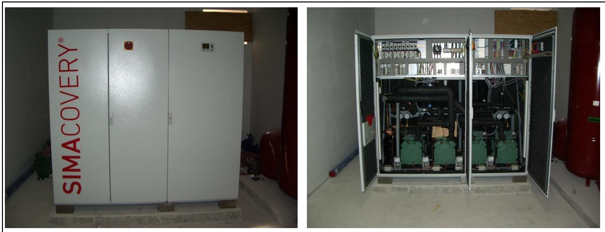
Abbildung 10: Elektrische Wärmepumpe ca. 170 kW, 4-stufig
