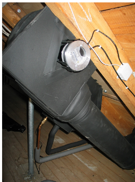
Abbildung 11: Ventilator-Wärmeübertrager-Einheit in Weißenhorn
