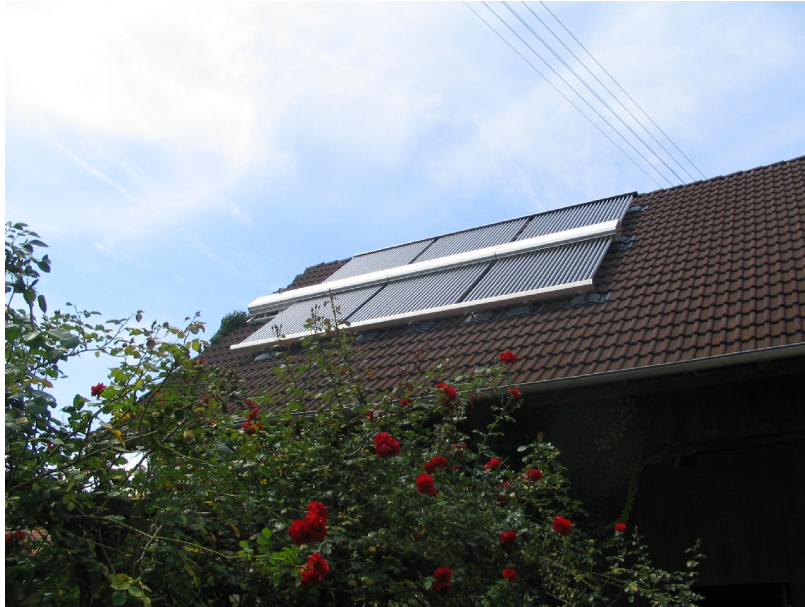
Abbildung 3: Kollektorfeld der Anlage Mengen0001
