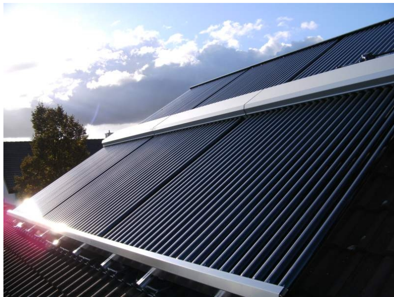
Abbildung 2: Kollektorfeld der Anlage Graben0001
