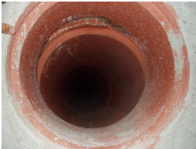
Abbildung 5-3: Durch unsachgemäßes Rohraufleger beim Verdichten abgerissene Rohrleitung [Dierkes, 2009]
