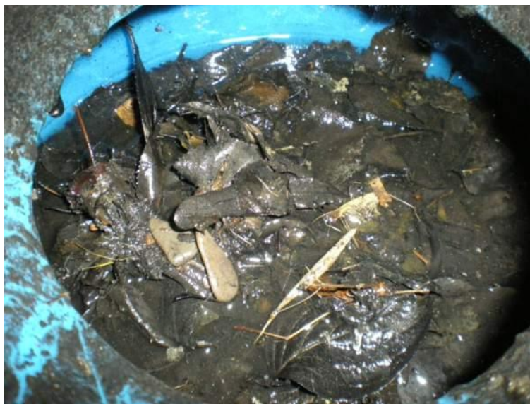
Abbildung 5-4: Schlammfang eines Filtersystems nach einem Jahr Betrieb [Dierkes, 2009]
