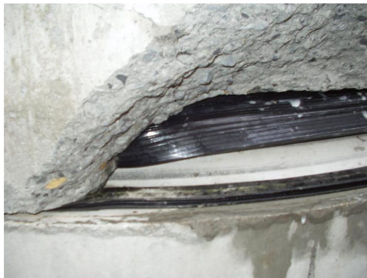
Abbildung 5-2: Schadhafte Stelle im Übergangsbereich von zwei Betonschachtringen; durch falsche Aufbringung der Dichtung wurde ein Teil des Betons herausgesprengt [Dierkes, 2009]
