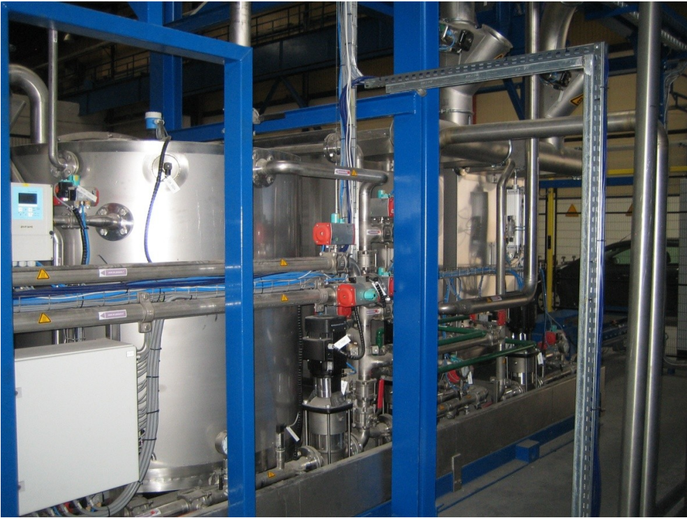
Abb. 17 Anlagenzustand bei geschlossener Bauweise der Pilotanlage
