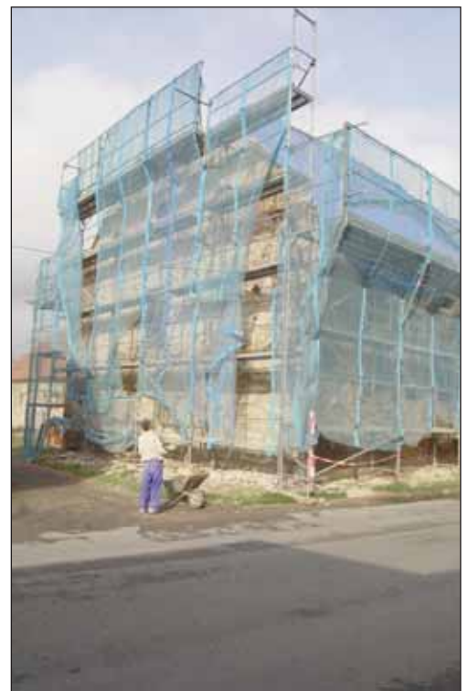
Der Speicher ist eingestübt
