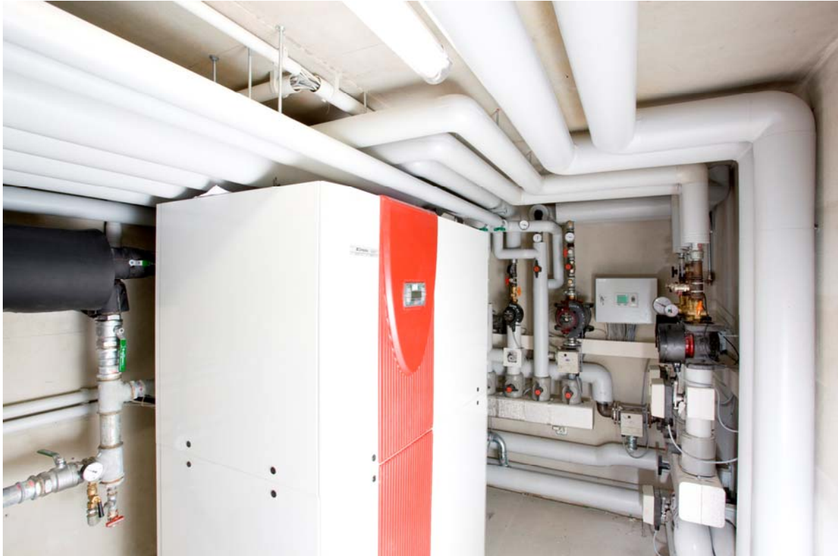
Abbildung 14: Blick in den Technikraum mit Wärmepumpe
