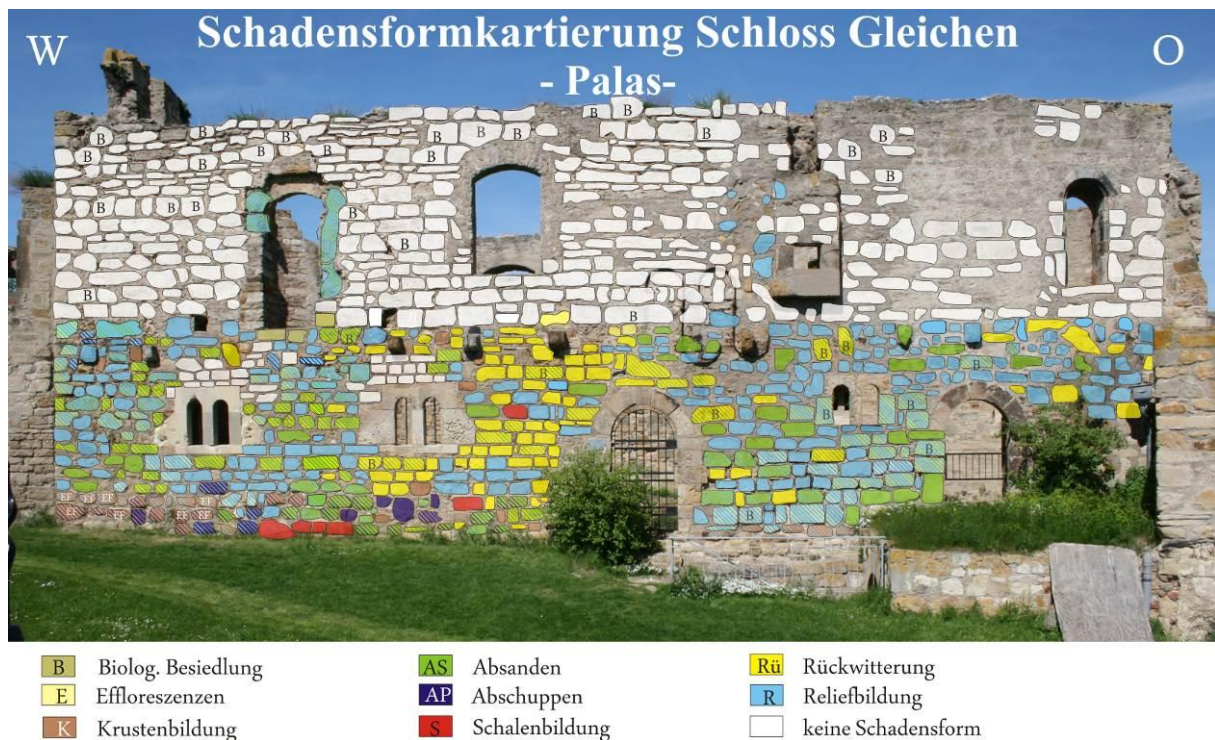
Abb. 14. Schadensformkartierung am romanischen Wohnbau (Palas) der Burg Gleichen. Primäre Schadensformen wurden als Füllfarbe, sekundäre als Schraffur und untergeordnete Schadensformen mit Buchstaben gekennzeichnet.
