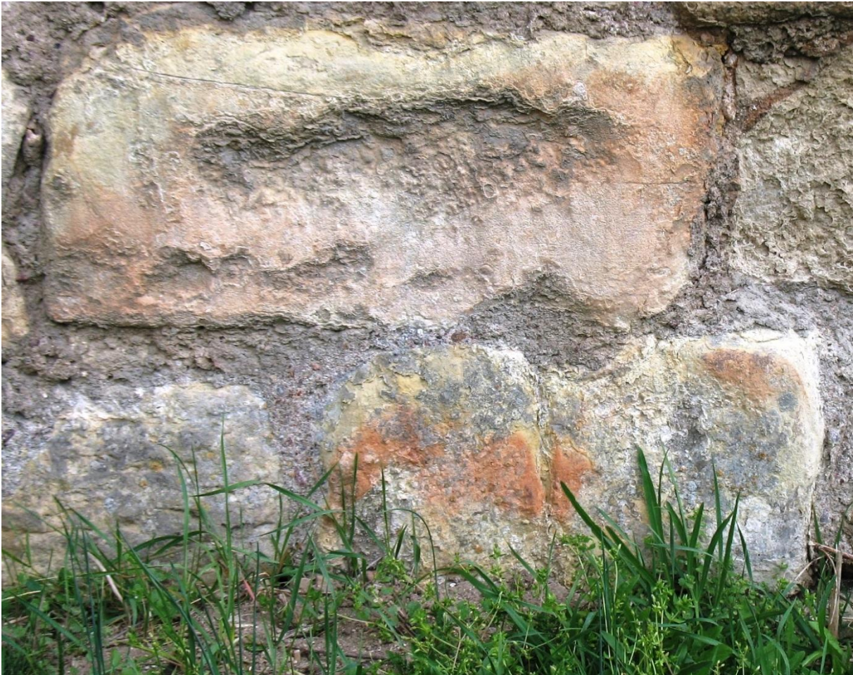
Abb. 4. Verschiedene durch Biodeterioration begleitete Verwitterungsformen auf Sandsteinen am Mauerfuß des romanischen Wohnbaus. Krustenbildung mit darunter befindlichem Algenbewuchs auf dem Gleichenberger Sandstein in der oberen Reihe, Flechtenbewuchs mit Abschuppen in der unteren Reihe auf Wachsenburger (links) und Gleichenberger Sandstein
