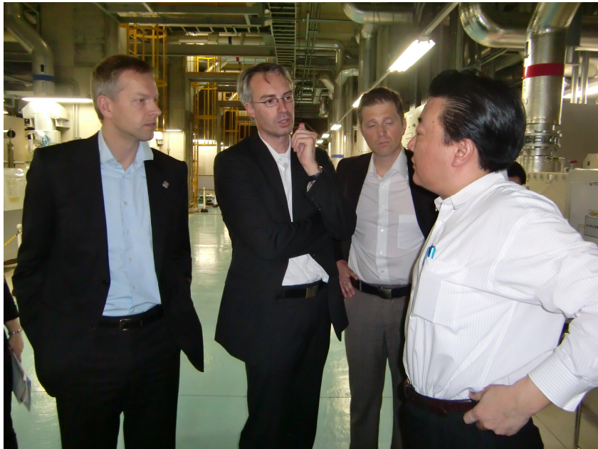
Im Herz der Anlage, umweltfreundliche Kälterzeugung, Kältespeicherung, Abwärmenutzung und „Fernkälteversorgung“ des Stadtteils „Harumi Island“.
