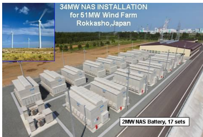
34 MW NAS-Batteriespeicher für einen Windpark in Nord-Japan (Quelle: Electricity Storage Association, 2009)
