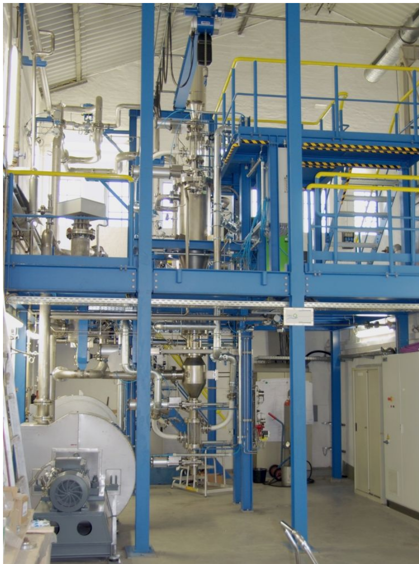
Abbildung 26: Versuchsanlage im BMA Technikum zur Wirbelschichttrocknung mit überhitztem Wasserdampf
