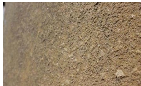
Abb. 89: Oberflächliche Ablagerungen, Fassade des Wohnhauses Schöneiche (Objekt-Nr.: 2590).
