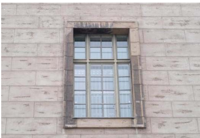
Abb. 485: In den 1980er Jahren erneuerter Steinputz Ostfassade Mittelbau Nord, Fenstergewände vermutl. bauzeitlich
