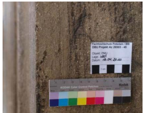
Abb. 500: Körnung an der Steinputzoberfläche durch Zementhaut kaum sichtbar, zu späte OF-Bearbeitung,
