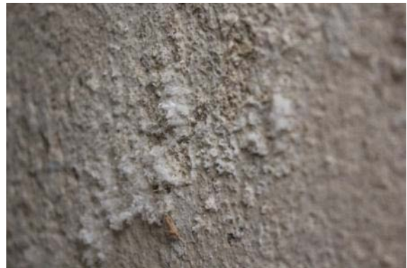
Abb. 95: Salzausblühungen an der Dorfkirche in Kroppen.
