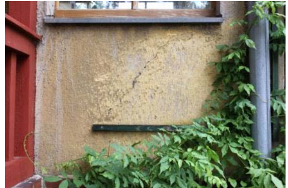
Abb. 109: Partielles Absanden am Haus Schöneiche (Objekt-Nr.: 2590), was teils bis zum Verlust zum Oberputz führte.
