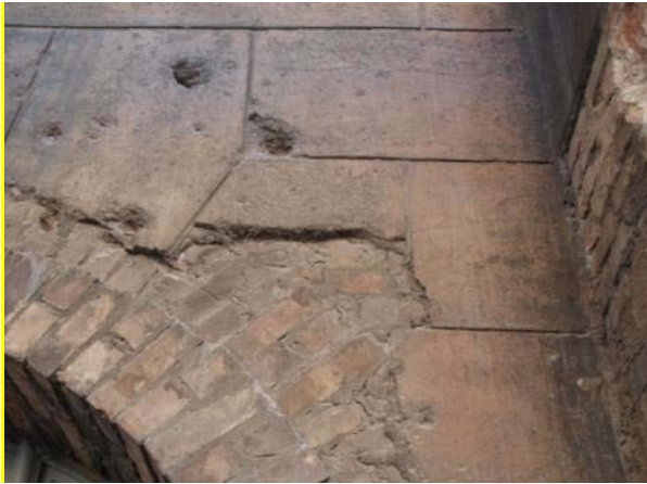
Abb. 492: Steinputz Nordfassade Nordflügel, kriegsbedingte Schäden: Ausbrüche, rötlich-braune Verfärbungen (evtl. durch Brand hervorgerufen)
