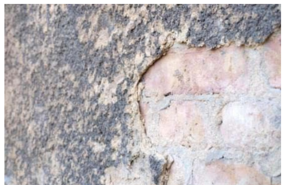
Abb. 129: Fehlstelle am Säuglingskrankenhaus in der Hansastraße (Objekt-Nr.: 4006).
