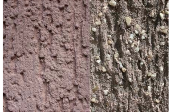
Abb. 142: Vergleich des Putzbestandes des Wohnhausblocks in der General-Barby-Straße (Objekt-Nr.: 2108) mit und ohne Fassung.
