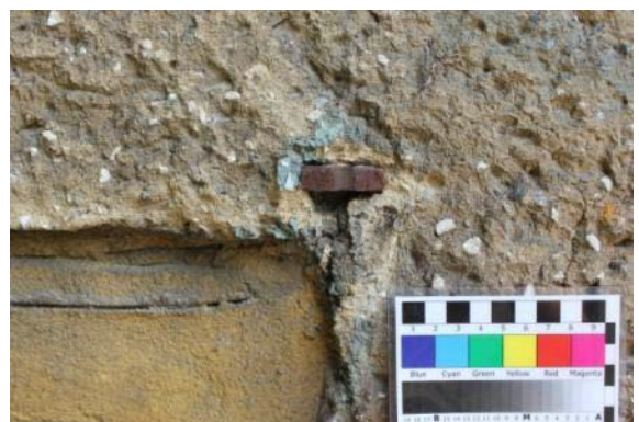
Abb. 124: Rissbildung bis hin zur Absprengung ganzer Putzschollen durch Metallkorrosion an der Kirche in der Baumschulenstraße (Objekt-Nr.: 4311).
