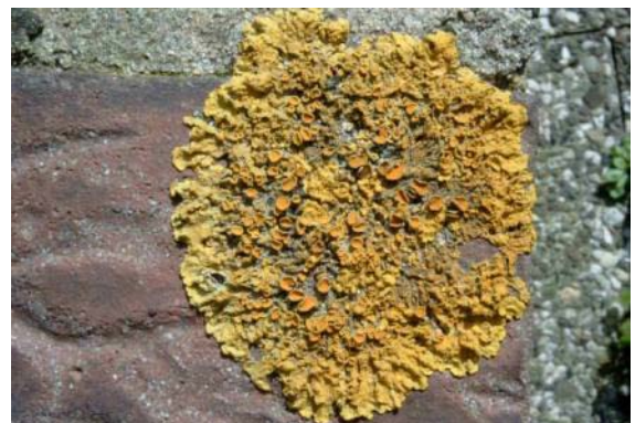
Abb. 99: Flechtenbewuchs an Ziegelmauerwerk.
