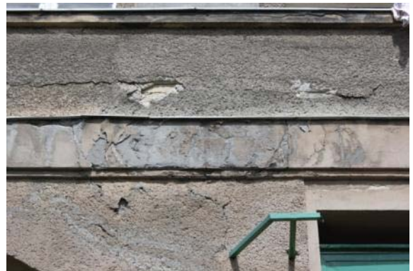
Abb. 122: Rissbildung, Schalenbildung und Teilverlust an der Fassade des Feuerwehrdepots in der Rathausstraße (Objekt-Nr.: 6104).
