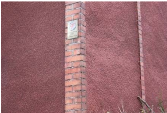
Abb. 113: Entfestigung des Putzes an der Wetterseite rechts. Die Fassade links ist sichtbar intakter. Onkel-Bräsig-Straße in der Hufeisensiedlung (Objekt-Nr.: 1200).
