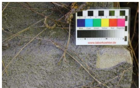
Abb. 133: Fehlstelle am Sockelbereich des Inspektorhauses des Krematoriums in Berlin- Wedding (Objekt-Nr.: 6301).
