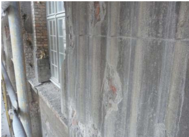
Abb. 493: Steinputz Nordfassade Mittelbau Nord, kriegsbedingte Substanzverluste
