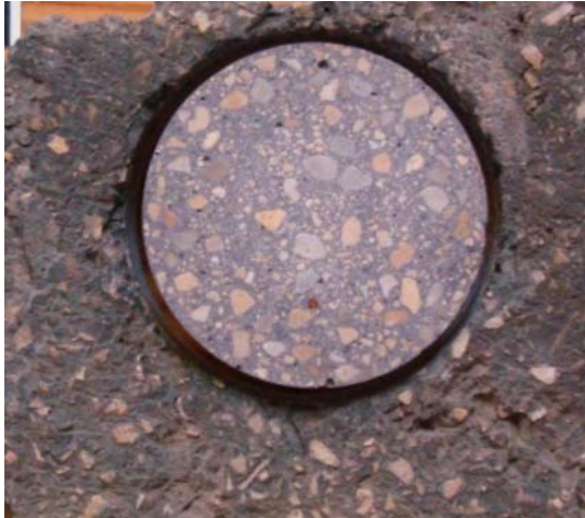
Abb. 565: Vergleich Steinputzmörtelprobe PrMi 03 mit Fragment Bestandsputz (bewitterte Oberfläche).
