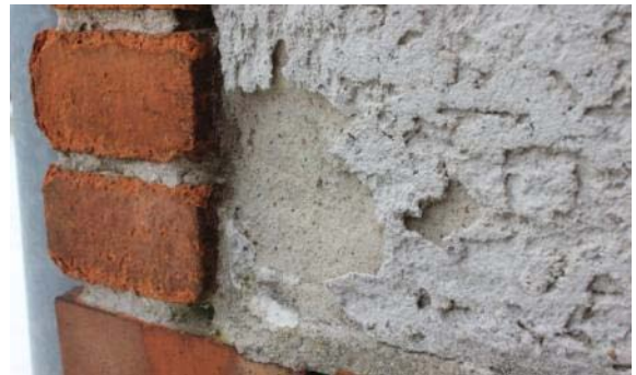
Abb. 126: Schalenbildung und Teilverlust des Oberputzes an der Paster-Behrens-Straße der Hufeisensiedlung (Objekt-Nr.: 1200).
