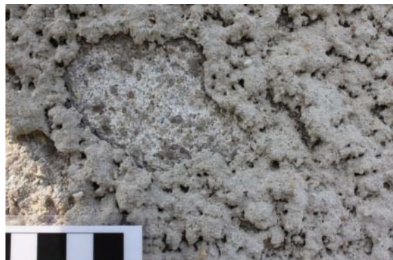
Abb. 135: Überputzung deutlich erkennbar an der Fehlstelle, die den weißen Putz freilegt. Konsumverein Lichtenberg (Objekt-Nr.: 5207).
