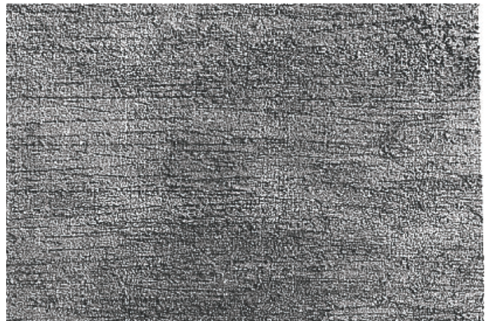
Abb. 59: waagrecht abgeriebener Putz mit vereinzelt leicht größerem Zuschlagskorn
