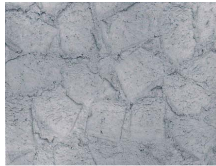
Abb. 28: Terranova- Eingedrückter Draufelputz
