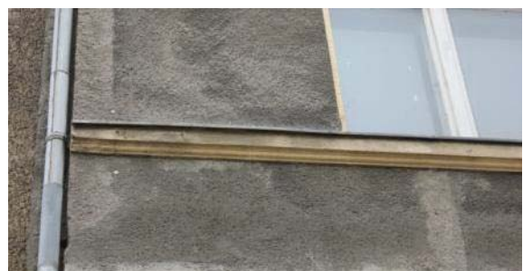
Abb. 118: defektes Wasserableitsystem am Wohnhaus Berliner Straße (Objekt-Nr.: 2206).
