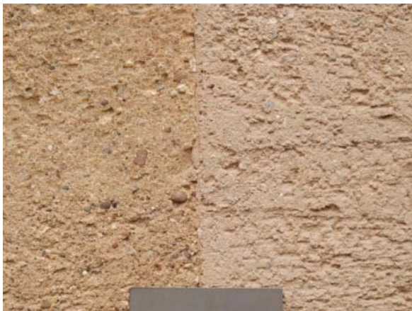
Abb. 473: Liebermann-Villa / Gärtnerhaus: links im Bild Originalputz in situ, rechts bei Sanierung 2002 nachgestellter Edelputz in situ
