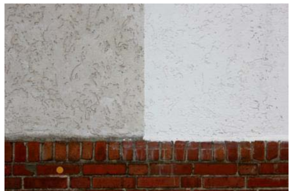
Abb. 140: Ansatzstelle eines überfassten Hausabschnittes zum ungefassten Bestand in der Dörchläuchtingstraße der Hufeisensiedlung (Objekt-Nr.: 1200).
