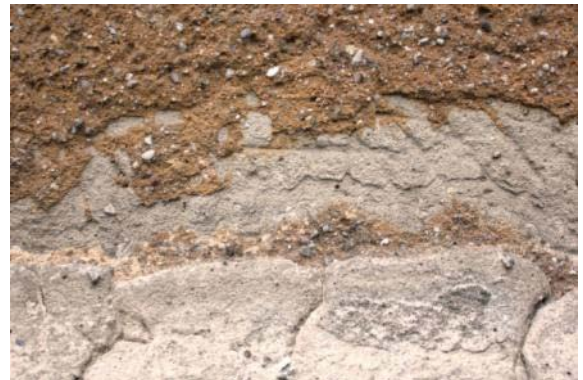
Abb. 111: Starkes Absanden an der Villa Amundsenstraße (Objekt-Nr.: 2588).
