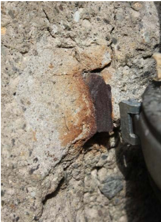
Abb. 104: Absprengungen und Verfärbung durch Metallkorrosion, Villa Baurat Walter. (Obj.-Nr.: 2506).
