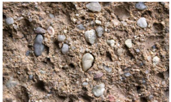
Abb. 405: Detailaufnahme der bearbeiteten Fläche mit abgearbeitetem Feinanteil und stark frei liegendem Zuschlagskorn
