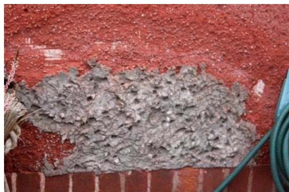
Abb. 146: Optisch in Farbe und Textur herausstechende Ergänzung an einer Fassade in der Liningstraße der Hufeisensiedlung (Objekt-Nr.: 1200). Die Abplatzungen am Original sprechen für eine zu hohe Härte der Ergänzung.
