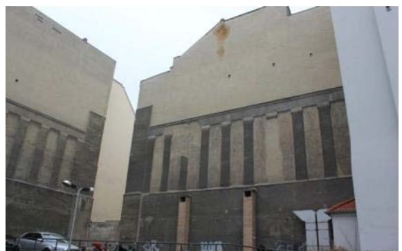
Abb. 132: Großflächige Verluste im Hinterhof des Theater am Nollendorferplatz, dem heutigen Goya-Club (Objekt-Nr.: 3007).
