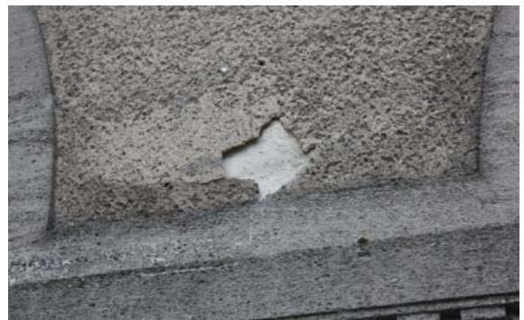
Abb. 128: Der Oberputz hat sich vom Unterputz getrennt und steht als Schale leicht von der Wand ab. Rathaus Spandau (Objekt-Nr.: 4210).
