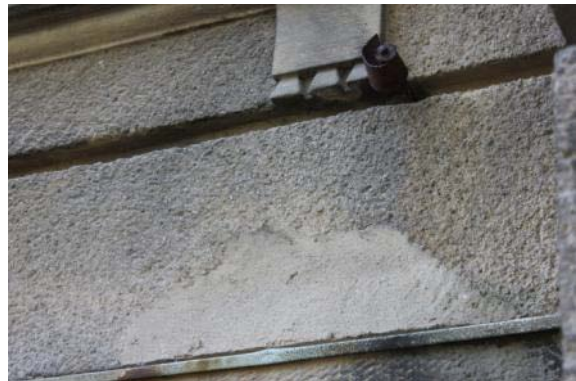
Abb. 145: Optisch unpassende Ergänzung an der Fassade des Rathaus Potsdam (Objekt-Nr.: 4212).
