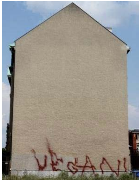
Abb. 144: Graffiti an der Brandmauer des Konsumvereins Lichtenberg (Objekt-Nr.: 5207).
