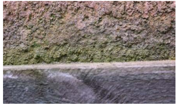
Abb. 98: Vergrünungen im Übergang zum Sockelbereich am Wohnhaus im Dinkelsbühler Steig 6 in Berlin- Fronau (→siehe auch Kapitel Reinigung).
