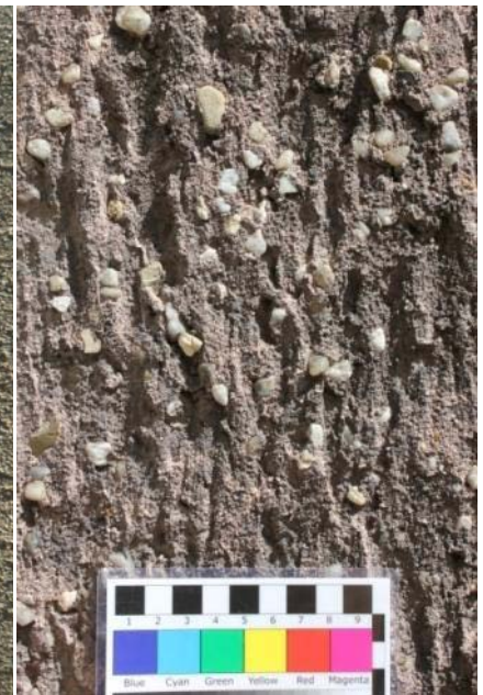
Abb. 55: Variation des Schleppputzes mit stark hervor springendem, grobem Zuschlagskorn
