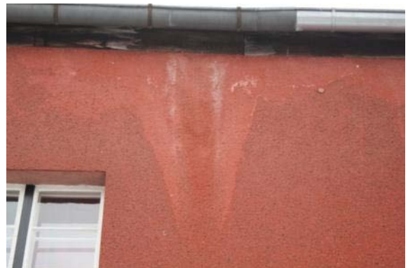
Abb. 120: Auswaschungen aufgrund einer defekten Regenrinne. Liningstraße in der Hufeisensiedlung (Objekt-Nr.: 1200).
