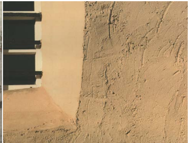
Abb. 19: Werkzeugspuren noch gut erkennbar
