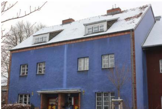
Abb. 115: Stark hervortretende Auswaschung an Fassaden in der Onkel-Bräsig-Straße in der Hufeisensiedlung (Objekt-Nr.: 1200).
