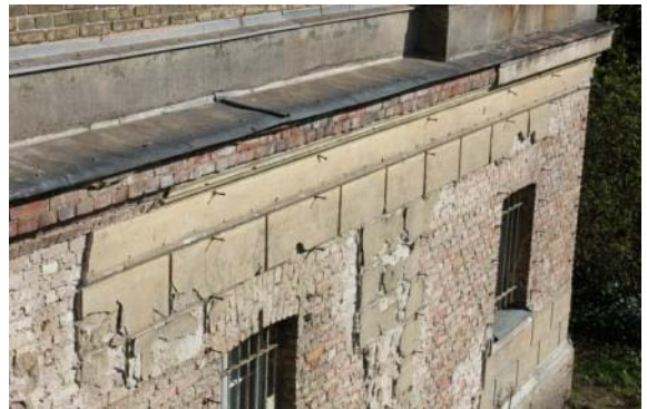
Abb. 131: Großflächiger Totalverlust des Putzes an der Orangerie im Schlosspark Sanssouci (Objekt-Nr.:3101).
