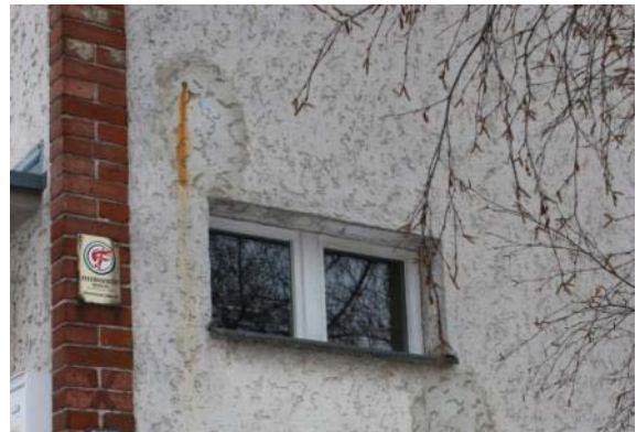
Abb. 107: Verfärbungen durch Metallkorrosion an einer Putzergänzung in Form einer Ablaufspur, Dörläuchtingstraße, Hufeisensiedlung (Objekt-Nr.:1200).
