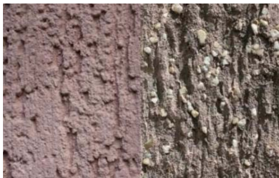
Abb. 149: General-Barby-Straße, links der überfasste Bereich und zum Vergleich rechts ein ursprünglicher Putzbereich.
