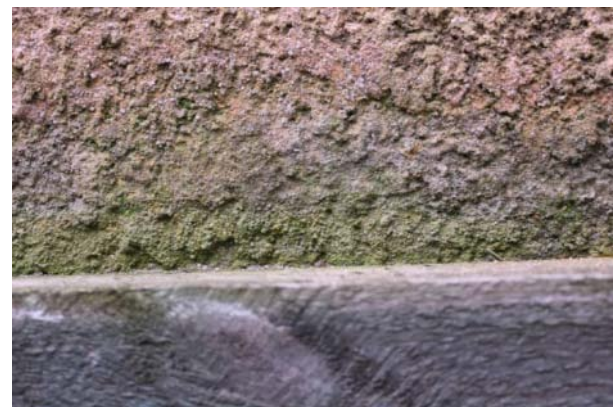
Abb. 400: Schadensbild mikrobieller Befall
