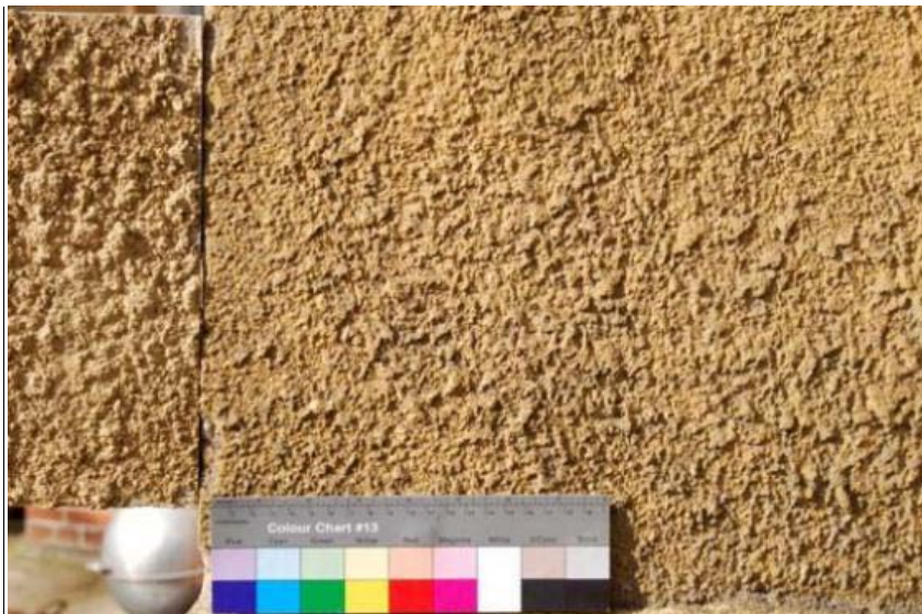
Abb. 476: Wohnhaus Schöneiche, links im Bild nachgestellter Edelputz auf Probeplatte, rechts Originalputz in situ
