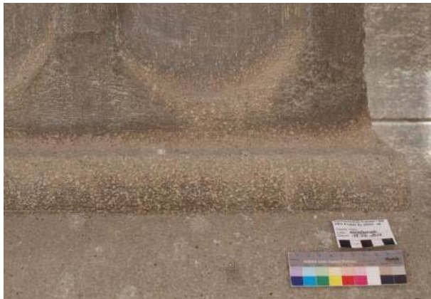
Abb. 501: Unterer Bereich der Kanneluren an der Pilasterbasis
