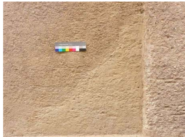
Abb. 474: Liebermann-Villa, Detailansicht mit Ausbesserung (2002) des Fassadenputzes
