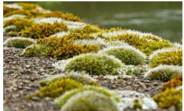
Abb. 100: Starker Moosbewuchs an feuchtigkeitsbelasteten Bereichen.
