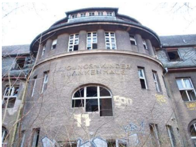
Abb. 150: Das Säuglingskrankenhaus in der Hansastraße zeigt ein umfangreiches Spektrum an Schadensbildern am Putzbestand. Zu erkennen sind beispielsweise Verschwärzungen, Fehlstellen, Absandende Bereiche und Graffiti
