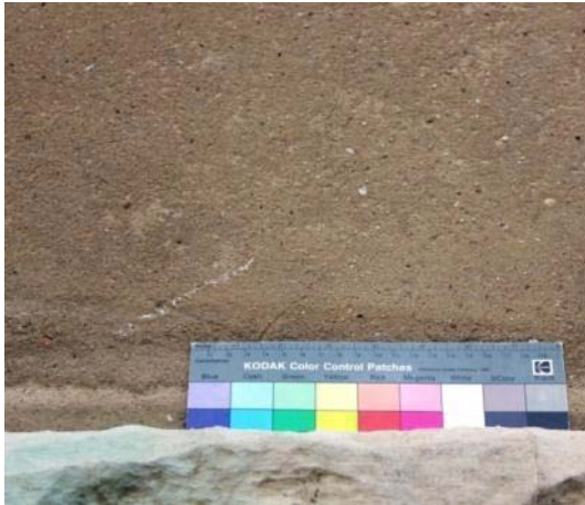
Abb. 56: verriebener Glattputz am Goethe-Gymnasium in Berlin. (Objekt-Nr.: 4320)
