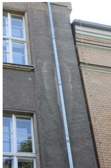
Abb. 121: Deutlich erkennbar ist hier die Auswirkung der Feuchtigkeitsbelastung durch das Wasserableitsystem in der Guerickestraße (Objekt-Nr.: 6107).
