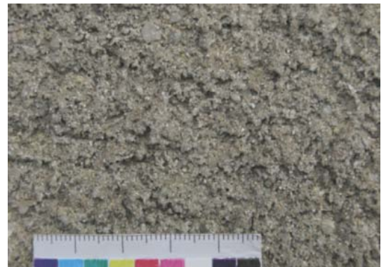
Abb. 265: KuFa Oberputz in situ, ungewöhnlich hohe Schichtdicke für Spritzputzausführung
