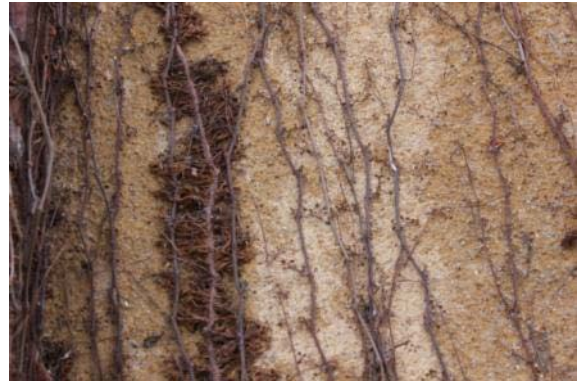
Abb. 105: Absanden und oberflächliche Entfestigung des Putzes, Miningstraße, Hufeisensiedlung (Objekt-Nr.:1200).
