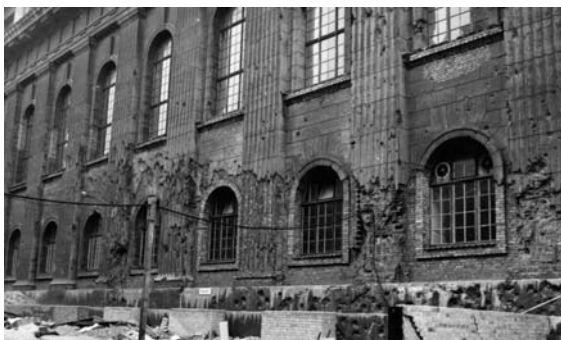
Abb. 130: Kriegsschäden am Pergamonmuseum (Objekt-Nr.: 3101). Historische Aufnahme.
