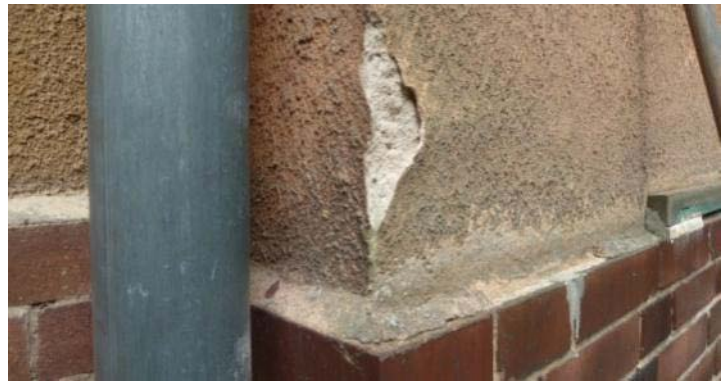
Abb. 398: Putzschäden im Spritzwasserbereich des überstehenden Sockels
