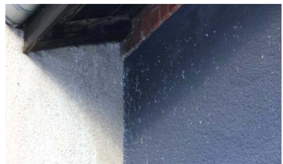
Abb. 94: Besondere Belastung durch Vogelkot im Bereich der Nistplätze von Mauerseglern in der Miningstraße der Hufeisensiedlung (Objekt-Nr.: 1200).
