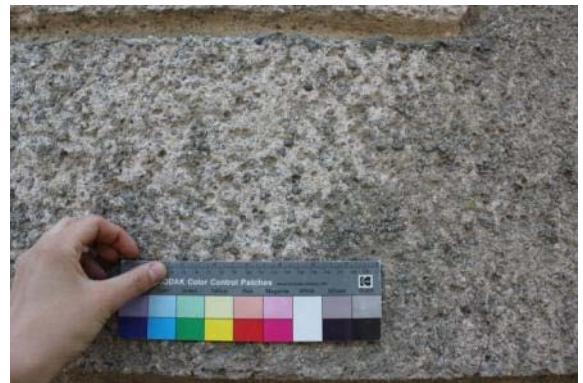
Abb. 110: Oberflächliches Absanden an der Villa Adlon (Objekt-Nr.: 2587).
