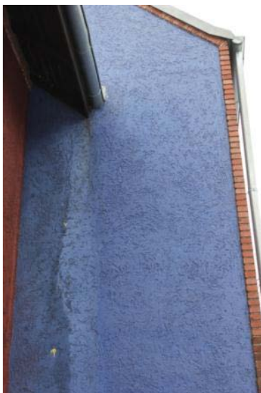
Abb. 116: Auswaschungen durch defektes Wasserableitsystem Onkel-Bräsig-Straße der Hufeisensiedlung (Objekt-Nr.: 1200).
