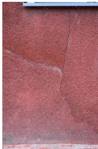
Abb. 123: Rissbildung, Onkel-Bräsig-Straße Nr.44 (Objekt-Nr.: 1200).
