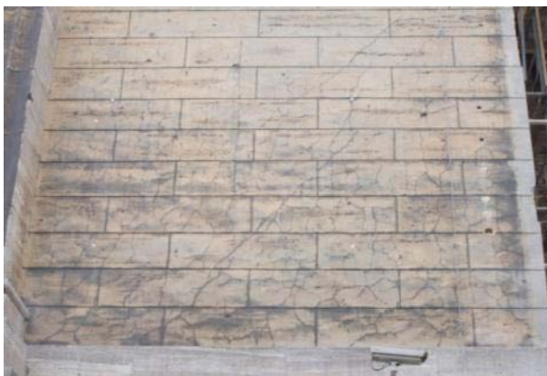
Abb. 494: Steinputz Nordfassade Mittelbau Nord, Craquelée
