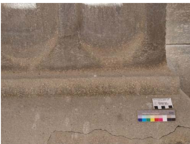
Abb. 497: Steinputz Nordfassade Nordflügel Pilasterreihe, Auswaschungen mit hell hervortretenden Kalksteinzuschlägen, oben Krustenbildung erkennbar. Unten im Bild konstruktionsbedingter Riss mit Hohllage
