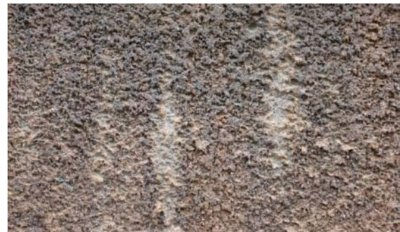
Abb. 92: Gipskrusten mit partiellen Auswaschungen oder durch mechanische Belastung entstandene Teilverluste. Wohnhaus im Dinkelsbühler Steig 6 in Berlin Fronau.
