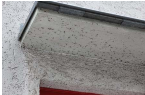
Abb. 106: Reste der Haftwurzeln und Haftscheiben nach Entfernen eines Bewuchses durch Haftwurzelkletterer, Paster-Behrens-Straße, Hufeisensiedlung (Objekt-Nr.: 1200).
