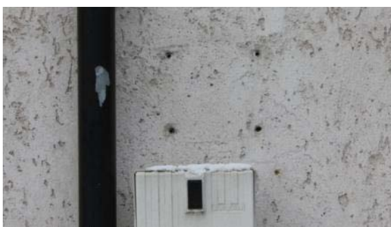
Abb.136: Alte Bohrlöcher in einer Fassade der Dörläuchtingstraße der Hufeisensiedlung, (Objekt-Nr.: 1200).
