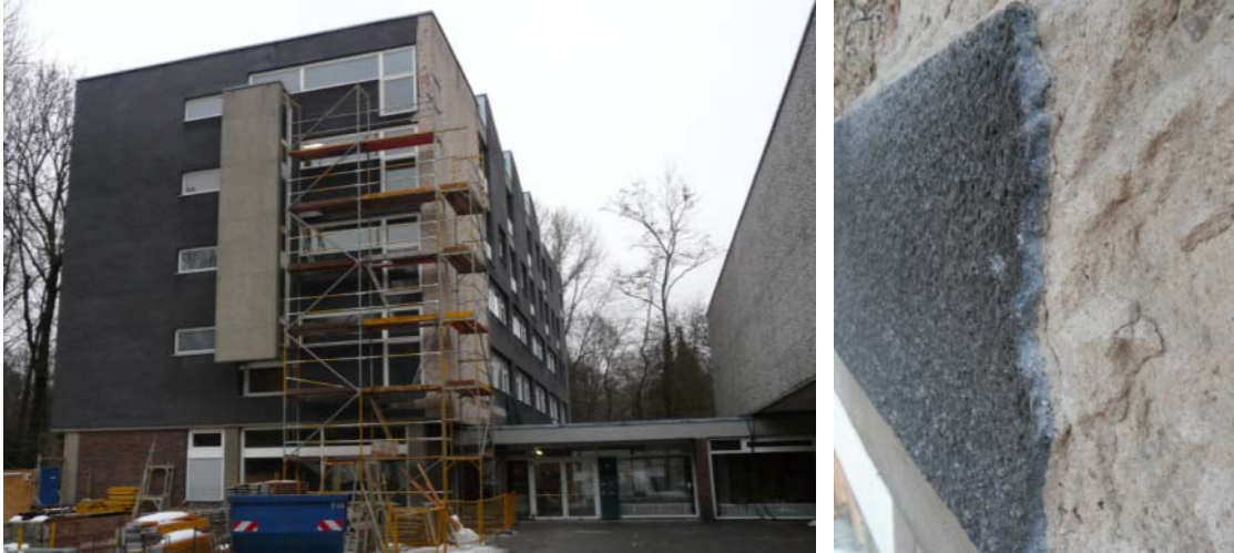
Abb. 229: Stark verdunkelter blauer Edelputz am Gebäude der AdK im Hanseatenweg
