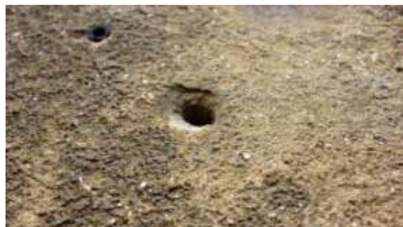
Abb.137: Bohrlöcher, teils noch mit Dübeln bestückt im Putz des Wohnhauses Schöneiche (Objekt-Nr.: 2590).
