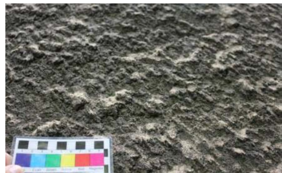
Abb. 88: Die gleichen Schadenphänomene (Gipskrusten) am Säuglingskrankenhaus in der Hansastrasse (Obj.-Nr.: 4006).
