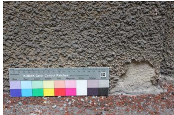
Abb. 91: Gipsbelastung führte teils zur Schollenbildung und zum partiellen Totalverlust. Wohnhaus im Dinkelsbühler Steig 6 in Berlin Fronau (→ siehe auch Kapitel Reinigung).
