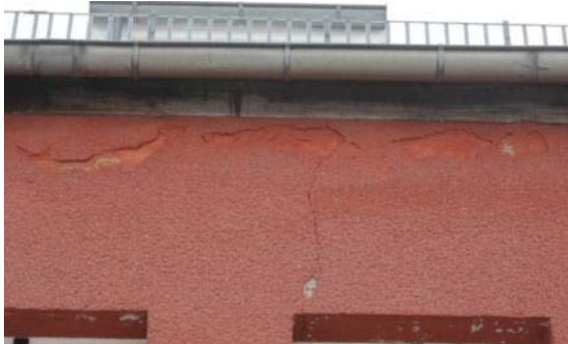
Abb. 125: Schollenbildung, Rissbildung und Teilverlust in der Liningstraße der Hufeisensiedlung (Objekt-Nr.: 1200).
