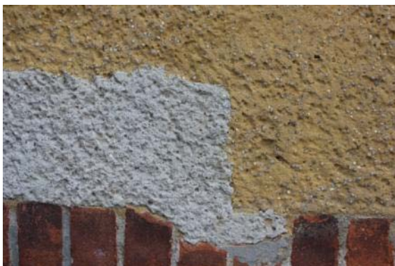
Abb. 147: In Textur gut passende, aber optisch nicht angepasste Ergänzung an einer Fassade in der Liningstraße der Hufeisensiedlung (Objekt-Nr.: 1200).
