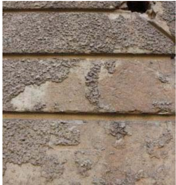
Abb. 134: Fehlstellen legen den darunter liegenden Putzbestand frei. Rathaus Potsdam (Objekt-Nr.: 4212).
