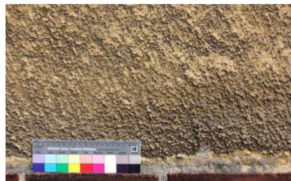
Abb. 90: Gipskrusten und Absanden am Wohnhaus Schöneiche (Objekt-Nr.: 2590).
