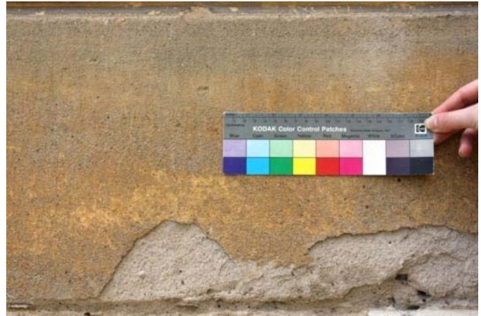
Abb. 57: verriebener Glattputz am Goethe-Gymnasium in Berlin. (Objekt-Nr.: 4320)
