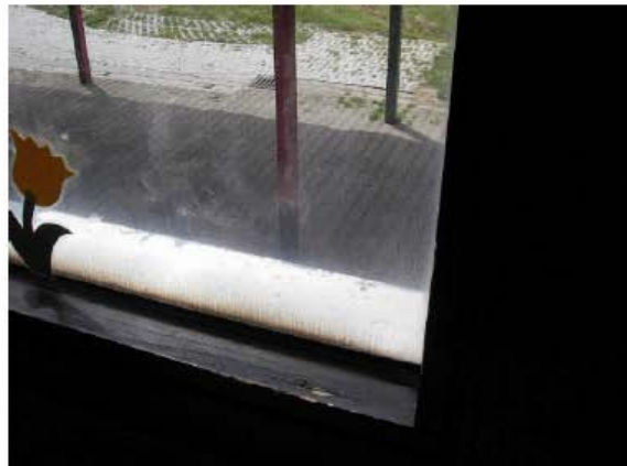
Abbildung 4.4 Verfärbungen im Scheibenzwischenraum
