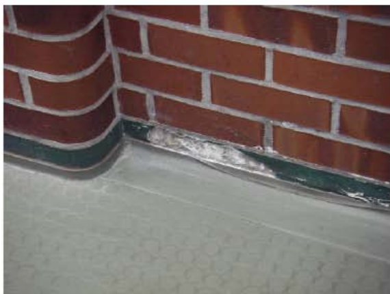
Abbildung 3.29 Ausblühungen an Wand zu Duschbereich
