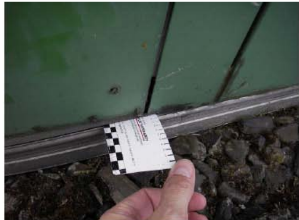
Abbildung 4.8 Schadhafter Wand-Anschluss der Dachabdichtung
