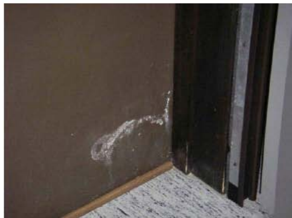
Abbildung 2.6 Ausblühungen an Wand gegen Erdreich in Lehrküche
