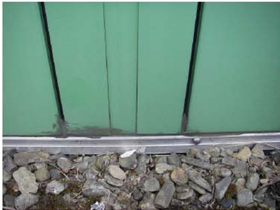
Abbildung 4.9 Anschlüsse an Fugen notdürftig „zugeschmiert“ – Funktion fraglich
