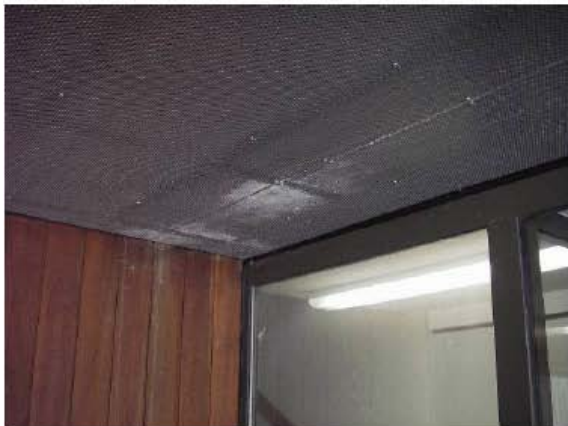
Abbildung 2.15 Feuchtespuren an abgehängter Lochblech-Decke im Bereich Lüftungskanal
