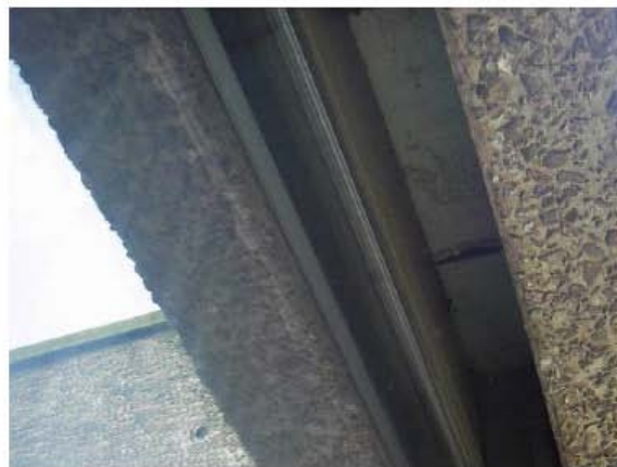
Abbildung 2.10 potentielle Wärmebrücke über Fenstern
