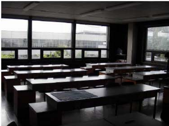
Abbildung 2.3 Schlieren in Scheibenzwischenraum – Scheiben im Öffnungsflügel z.T. bereits ausgetauscht
