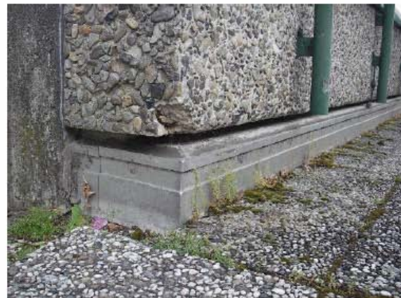
Abbildung 2.18 Betonabplatzung an der Ecke – so genannte „dauerelastische Wartungs-Fuge“ als Anschluss der Dachabdichtung ohne konstruktive Überdeckung.
