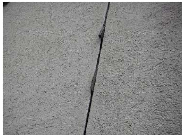
Abbildung 3.18 Teile des Dichtbands sind bereits herausgefallen
