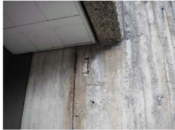
Abbildung 2.20 Betonschaden an Stützwand vor Erdreich. Geringe Betonüberdeckung
