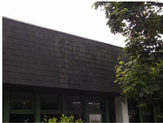
Abbildung 4.16 Attika Nordseite – Moosbewuchs
