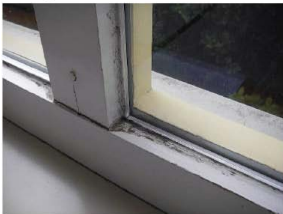
Abbildung 3.21 Alte Turnhalle – Lackschäden am Fenster
