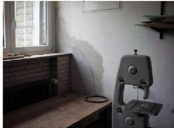
Abbildung 3.16 Alter Feuchteschaden in Werkraum (Fachtrakt)
