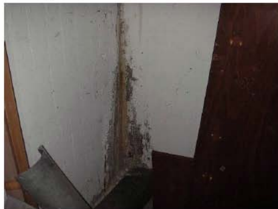
Abbildung 2.12 Feuchte Wandecke in Technikbereich 2.UG
