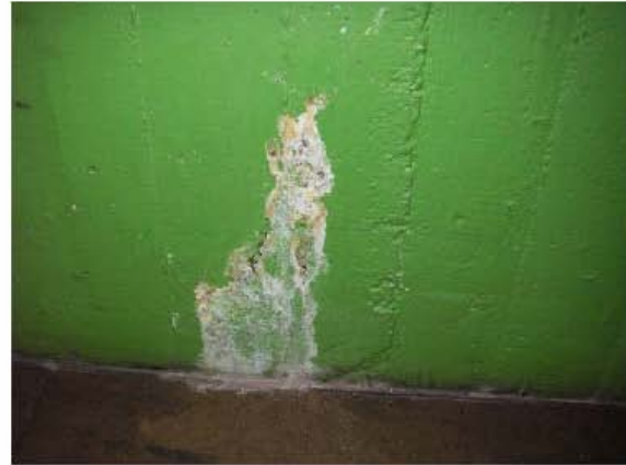
Abbildung 2.14 Ausblühungen bei Raum 113 im Bereich von Haarrissen
