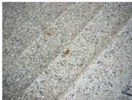
Bild 13: Treppe mit freiliegender rostiger Bewehrung
