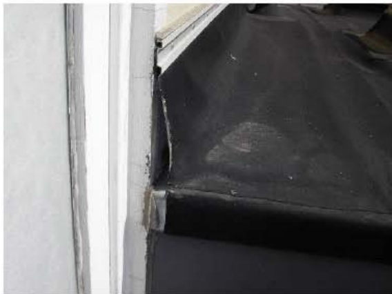
Abbildung 3.5 Fehlender Abschluss links
