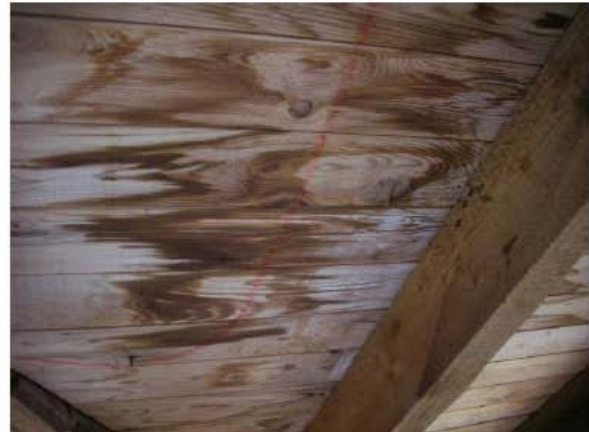
Abbildung 3.10 Spuren alter Undichtigkeiten im Dach Fachtrakt an Holzbauteilen
