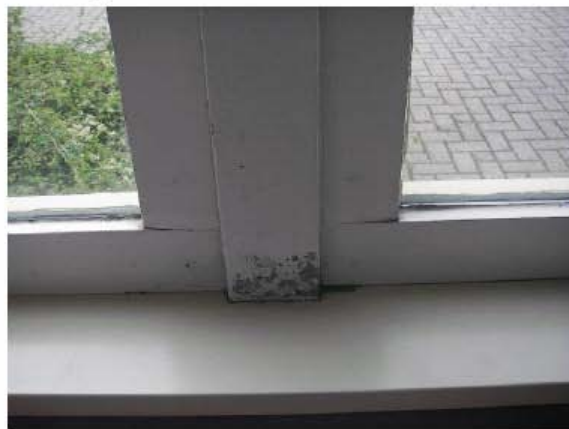
Abbildung 3.22 Alte Turnhalle – Lackschäden am Fenster und Wärmebrücke einbetonierter Stahlträger
