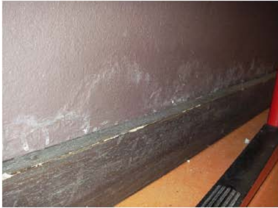
Abbildung 4.13 Ausblühungen im Sockelbereich (Südseite)
