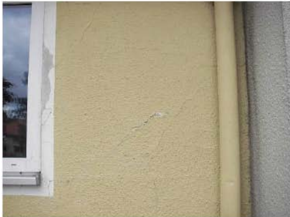
Abbildung 3.13 Risse und hohle Stellen im Putz – eingeschossige Verbindung zu den Sporthallen
