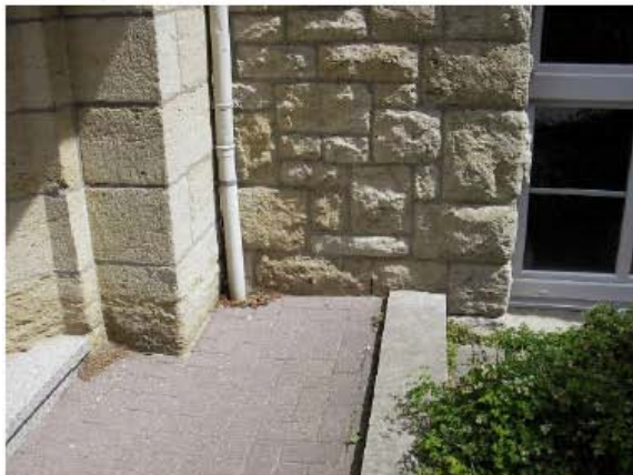
Abbildung 3.27 Im Raum Cafeteria war auf (früher erstellter) Thermografie im Bereich hinter dem Fallrohr eine kältere Stelle auf der Innenoberfläche der Wand
