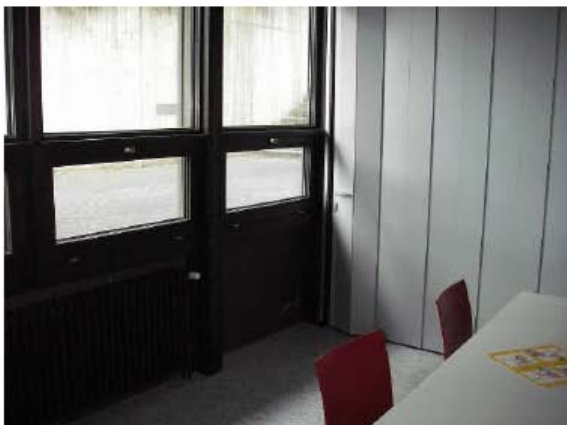
Abbildung 2.5 Lehrküche - Wand gegen Erdreich
