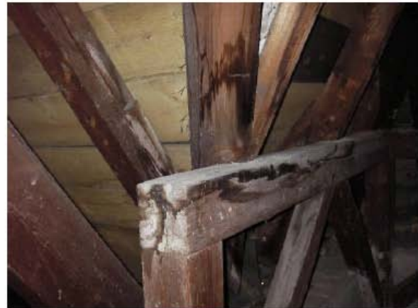
Abbildung 3.8 Spuren alter Undichtigkeiten im Dach Hauptgebäude an Holzbauteilen
