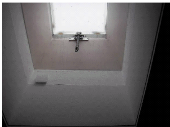
Abbildung 3.31 Dieses Oberlicht liegt über der feuchten Stelle des vorigen Bildes.
