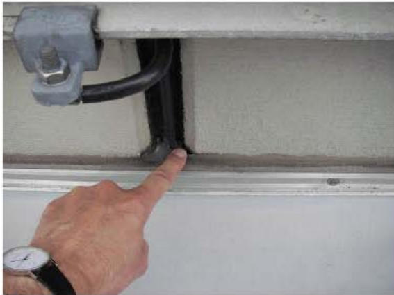
Abbildung 2.21 Anschluss Dachabdichtung an Attika im Stoßbereich der Fertigelemente. Silikon haftet nicht.
