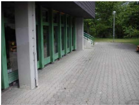
Abbildung 4.15 Die selbe Wand von außen – Gefälle zum Gebäude – funktionierende Drainage?
