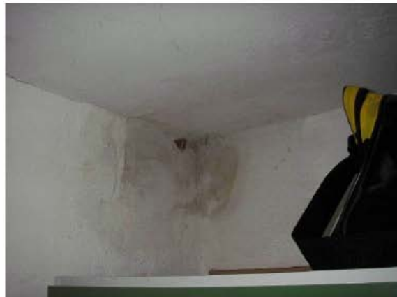
Abbildung 3.24 Alter Rohrbruch Musikvorbereitung
