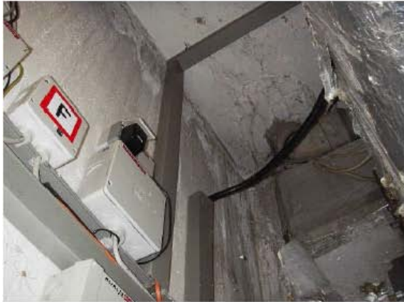
Abbildung 2.13 Feuchte Wand Elektroanschlussraum
