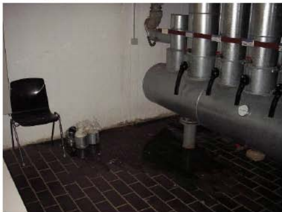
Abbildung 2.11 Pfütze in Technikbereich 2.UG
