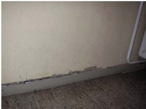
Abbildung 3.23 Feuchtigkeit am unterer Gebäudeabschluss Cafeteria
