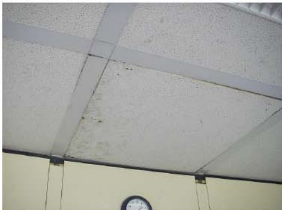
Abbildung 4.5 Wasserspuren einer alten Undichtigkeit im Dach des Obergeschosses
