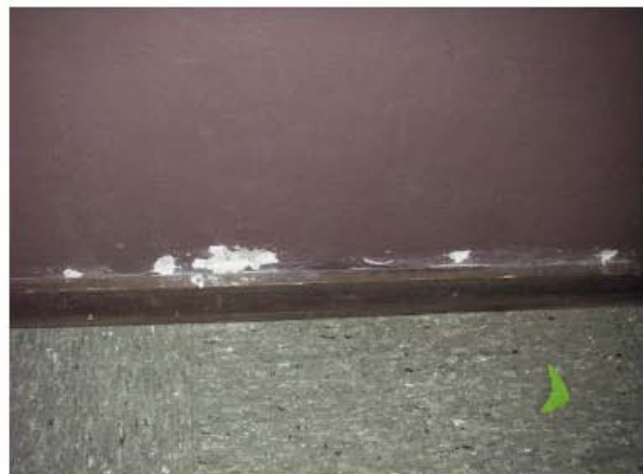
Abbildung 4.12 Ausblühungen im Sockelbereich (Südseite)
