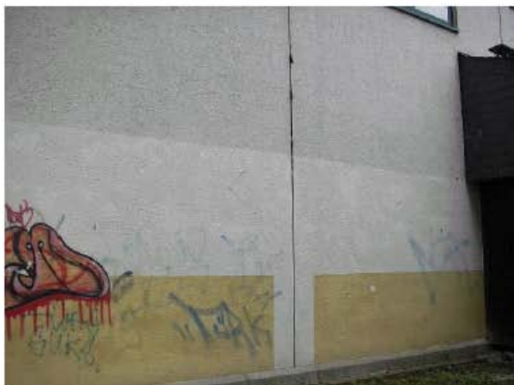
Abbildung 3.17 Neue Sporthalle Rückseite mit Vandalismus- Schäden im Wärmedämm-Verbundsystem
