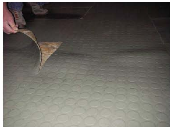
Abbildung 3.30 Feuchte Stellen in Fußboden einer Umkleide
