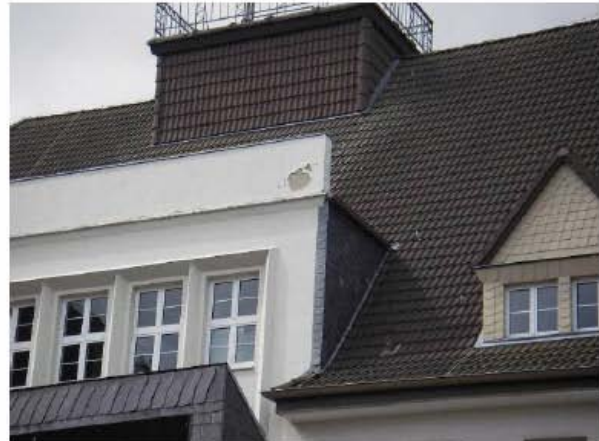
Abbildung 3.14 Putzschaden an Gaubenvorderwand
