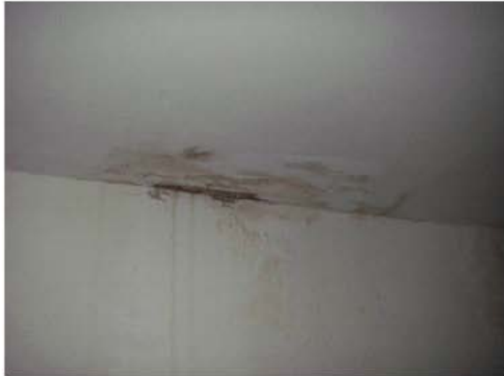
Abbildung 3.25 Alter Rohrbruch Musikvorbereitung
