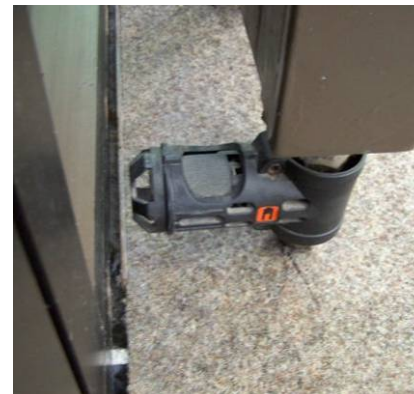
Abbildung 42 Thermostatventil Flur OG
