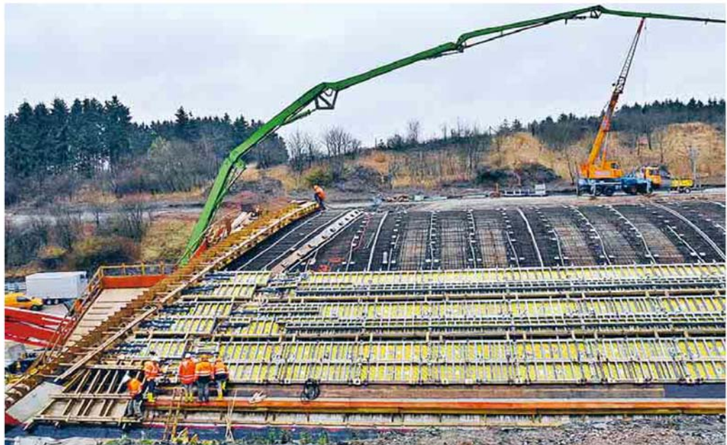
Die Arbeiter hatten die Aufgabe, eine enorm große Fläche gleichmäßig und symmetrisch mit Beton zu verfüllen.
