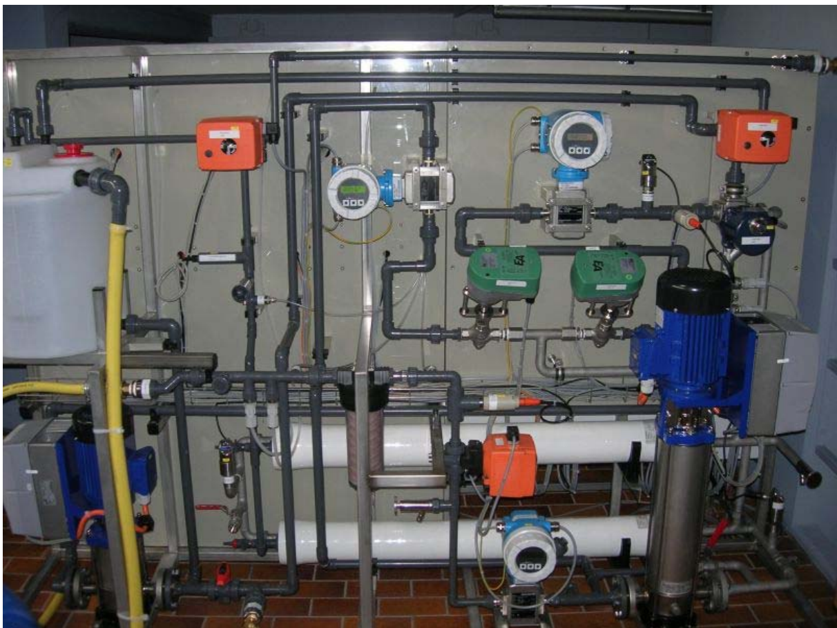
Bild 3.1: Ansichten der LPRO-Pilotanlage. Oben: Steuerung und Dosierung. Unten: Permeatbehälter und Spülpumpe, zwei Stück 4" - LPRO-Membran-elemente und Hochdruckpumpe
