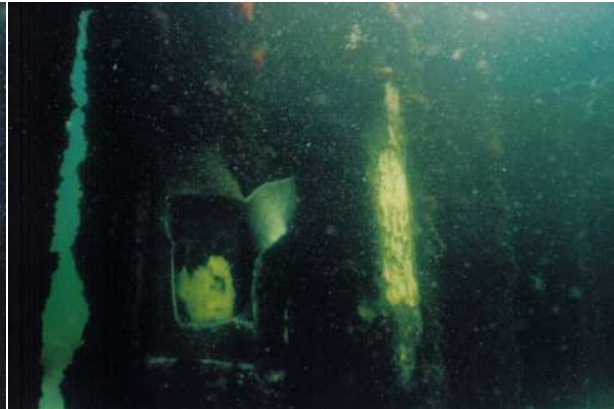
Abbildung 3: Pfähle nach Entfernung des Bewuchses
