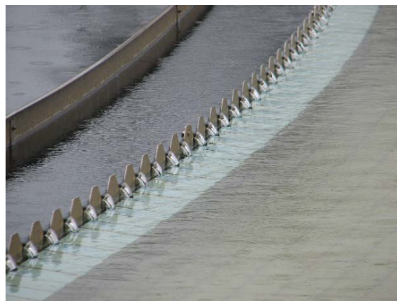
Bild 5: eingestaute Ablaufrinne eines Nachklärbeckens und vollkommener Überfall an der Zahnschwelle
