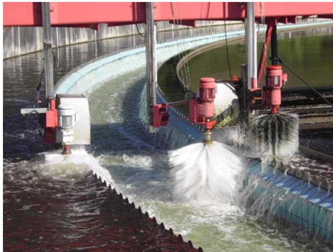
Bild 4: Überfallhöhe an der Zahnschwelle eines Nachklärbeckens bei Trockenwetter
