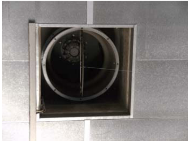
Bild 2: Klappen mit Abluftventilatoren
