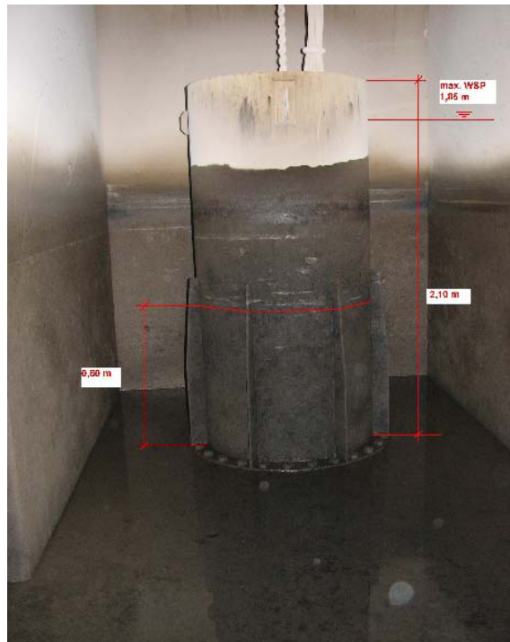
Bild 6: Druckseitige Ansicht eines Rohrschachtes
