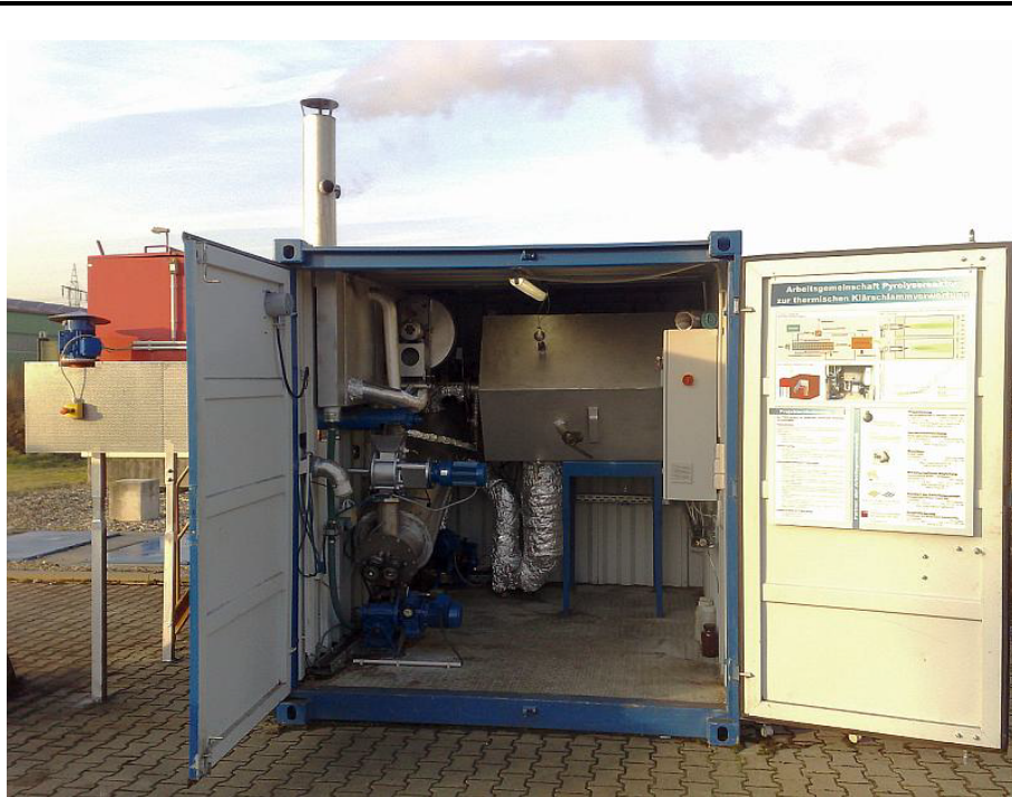
Ansicht der Pilotanlage auf der Kläranlage in Ingelheim
